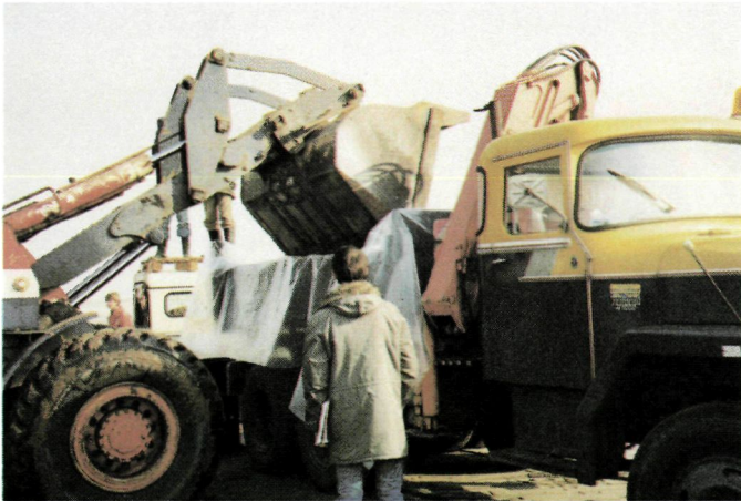
Met een vrachtwagen wordt de mousse van proefvak A afgevoerd naar de 150 m verder gelegen tussenopslag.
