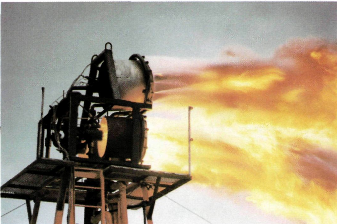
De driekoppige branders. De twee onderste zijn ondersteuningsbranders die met gasolie worden gestookt; door de bovenste wordt het te vernietigen mengsel verbrand.
