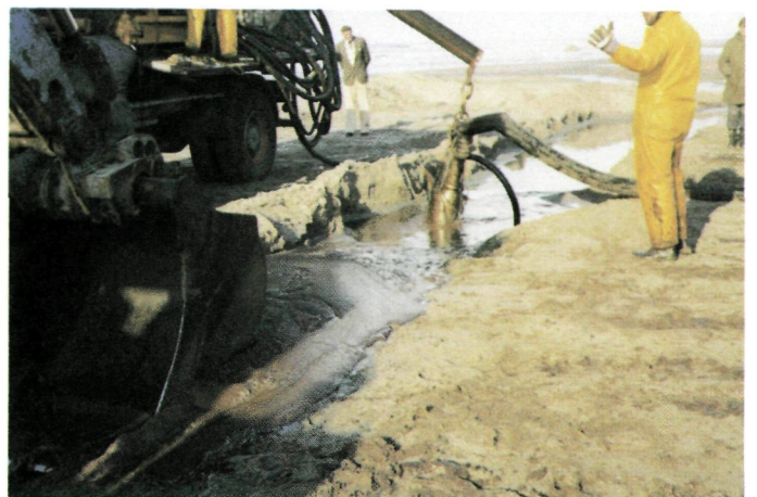
De natuurlijke toestroming van de in de sleuf verzamelde mousse naar de pomp is onvoldoende.
