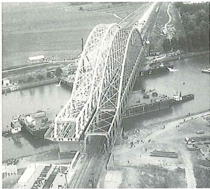
10. Overbrugging van het Amsterdam-Rijnkanaal bij Weesp. Rechts de dubbelsporige, grotendeels geklonken, verstijfde staafboogbrug uit 1972. Links daarnaast de tweede, nagenoeg geheel gelaste, eveneens dubbelsporige brug van hetzelfde type tijdens het invaren in 1995. (foto NS)
