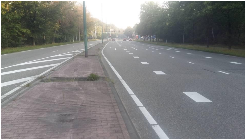
Figuur 13: Foto's schouw.
