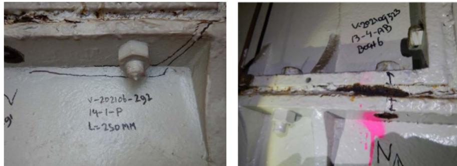
Figuur D 1 Voorbeelden van scheuren in de flens (foto's 7248 en 8436 uit [4]).
