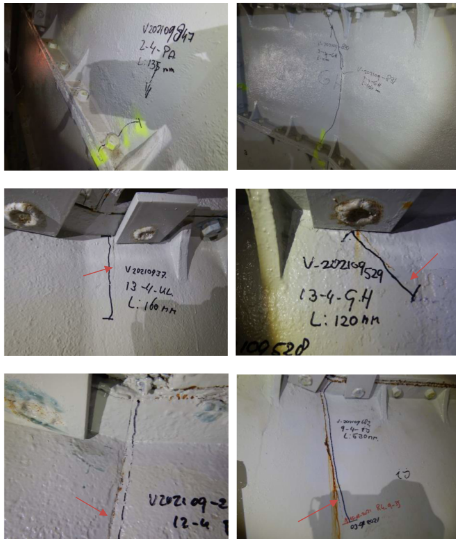
Figuur D 2 Voorbeelden van scheuren in het lijf (foto's 9150, 9117, 8467, 8450, 4190 en 8796 uit [4]).
