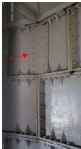
Figuur D 10 Foto van een eerder (ongedateerd) aangebrachte plaat die tegen het lijf is gebout.
