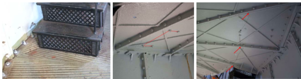
Figuur D 5 Voorbeelden van scheuren dwars door de vloerpanelen (foto's uit [8]).
