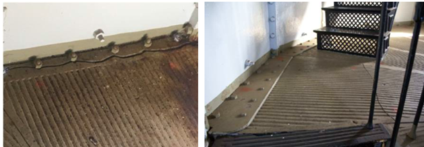
Figuur D 7 Voorbeelden van scheuren in de vloer (foto links uit [3], rechts uit [8]).
