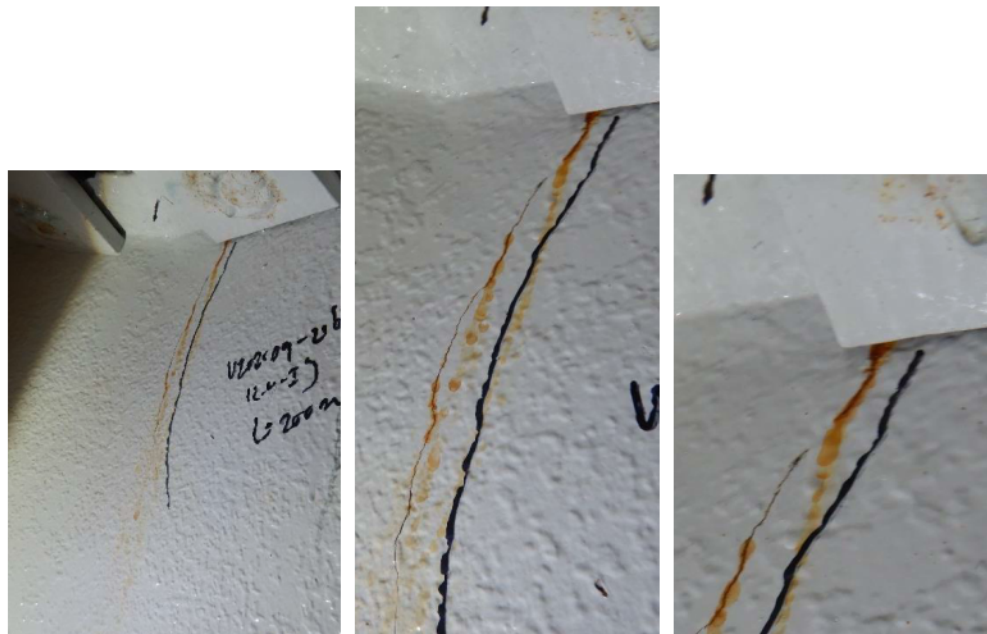
Figuur D 13 Foto's van een scheur is ontstaan of gegroeid na het aanbrengen van de conservering (foto's 4206 en 4207 uit [4]).
