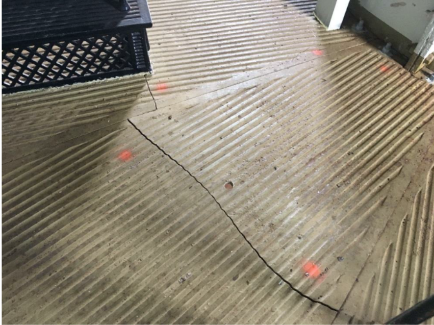
Figuur 2: scheur door vloerplaat heen
