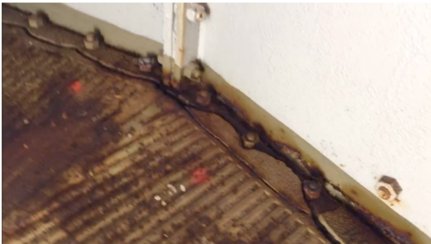
Figuur 7: scheurvorming langs vloerrand bij buitenschacht
