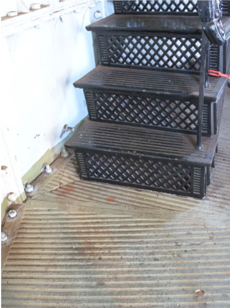
Foto 6 Vloer laag 15 met trapoplegging - niet fraai maar er zijn wel alternatieve draagwegen mogelijk
