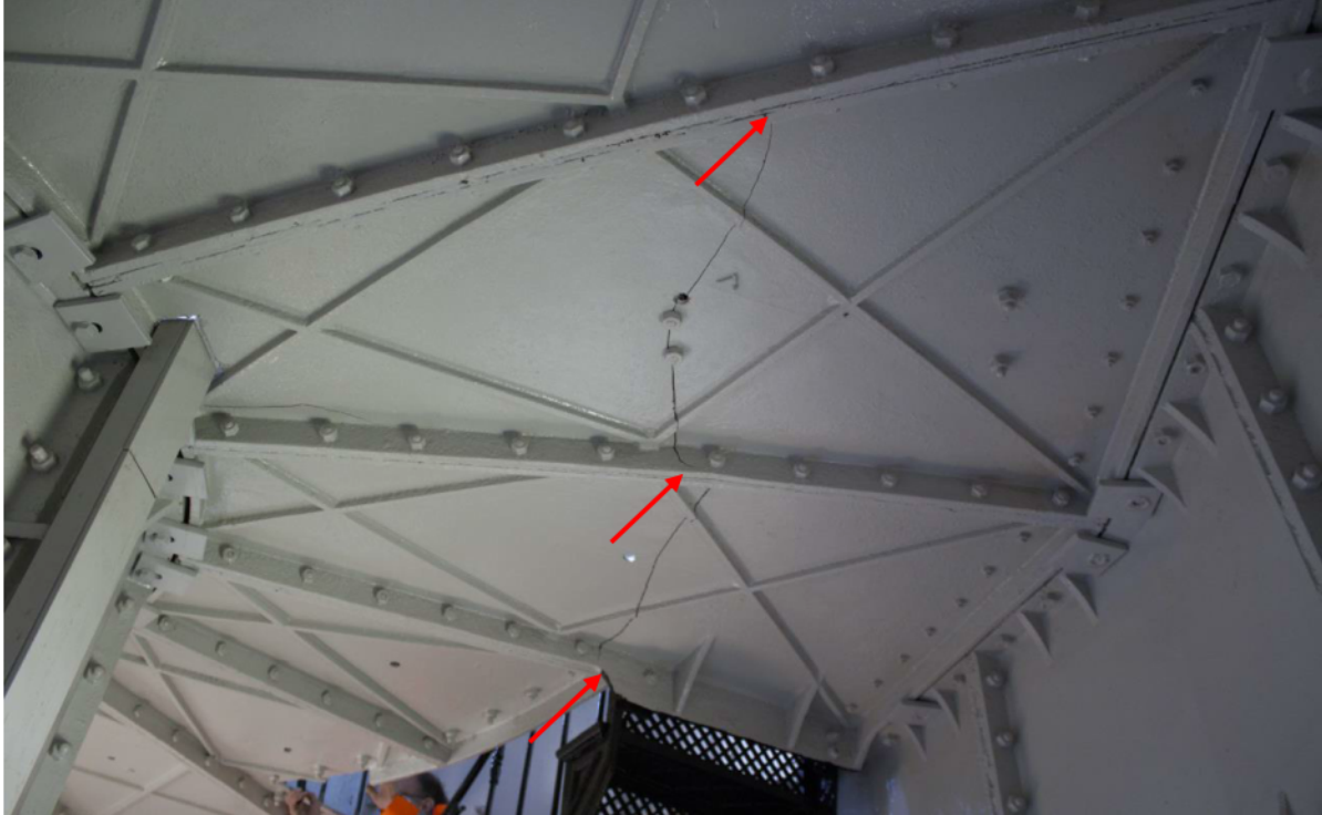
Foto 1 Vloer laag 13 met drie doorgescheurde ribben
