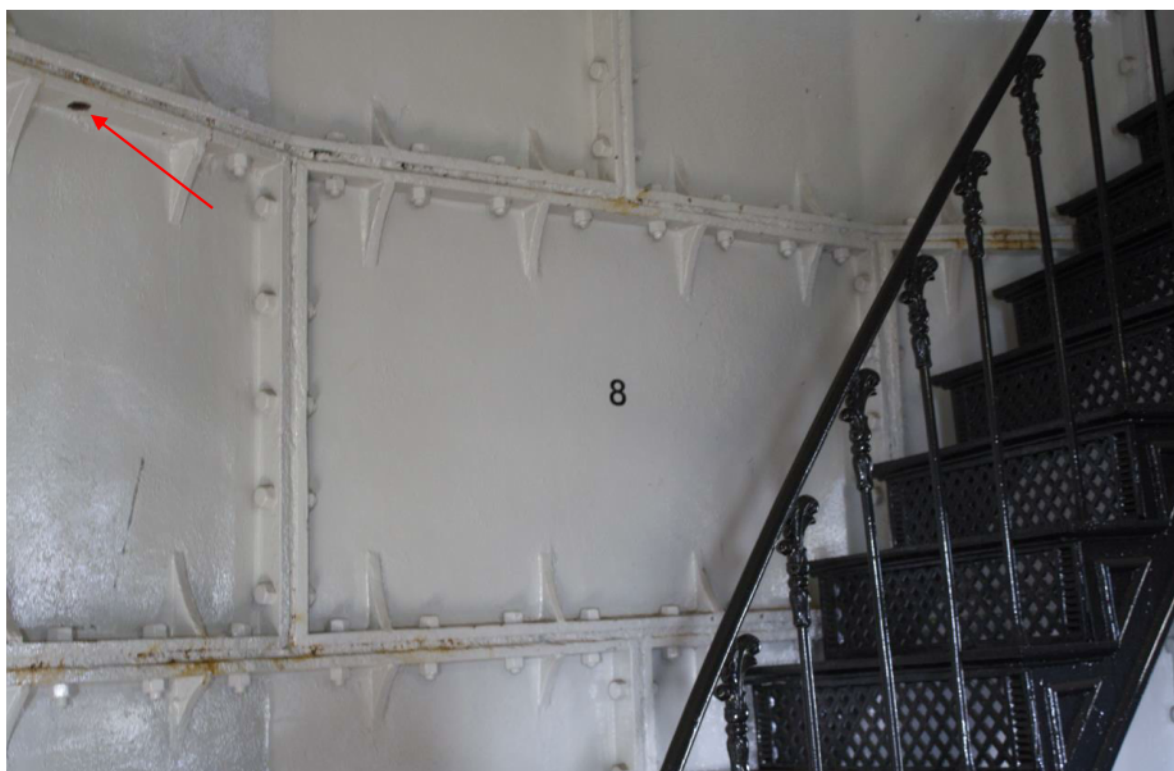
Foto 12 Vooral op laag 8 ontbreken verschillende bouten in de buitenschil
