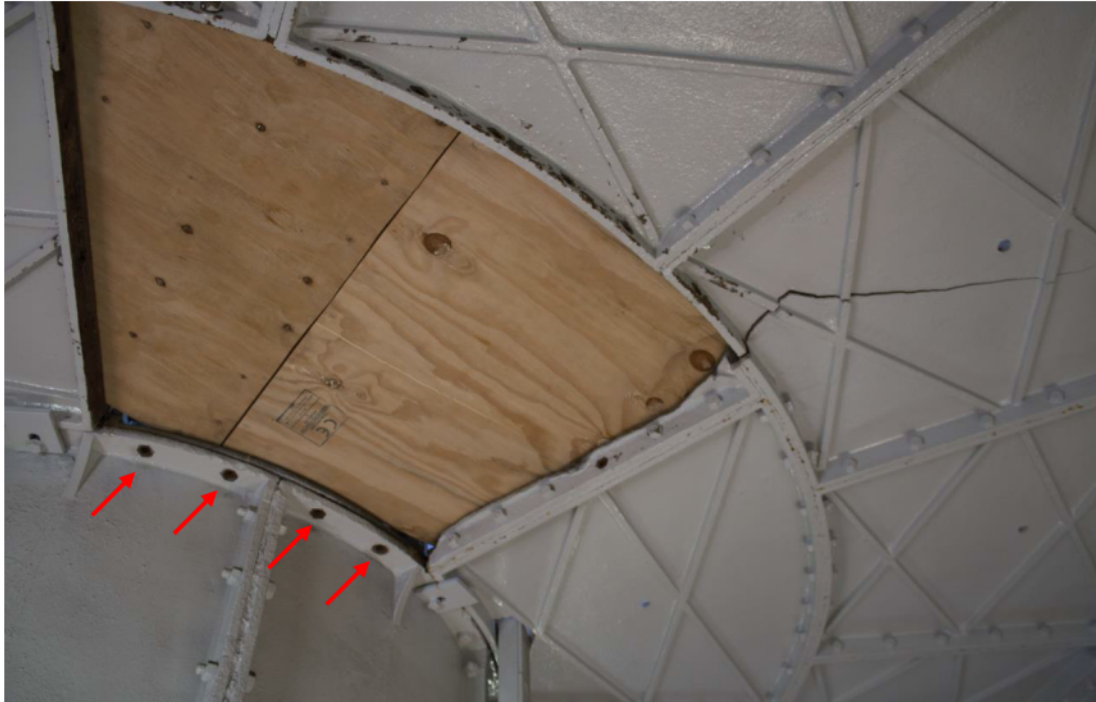
Foto 9 Verwijderd vloerdeel op de 12 e verdieping – hier moeten bouten terug geplaatst worden
