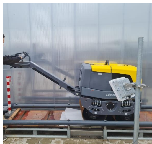
Figuur 4 Asfaltwals waarmee het asfalt wordt verdicht. Om de metalen paal hangt de RFID uitlezer.
