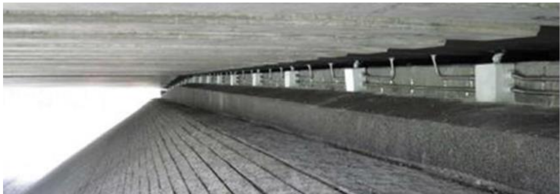
Figuur 5 - Kathodische bescherming in viaduct
