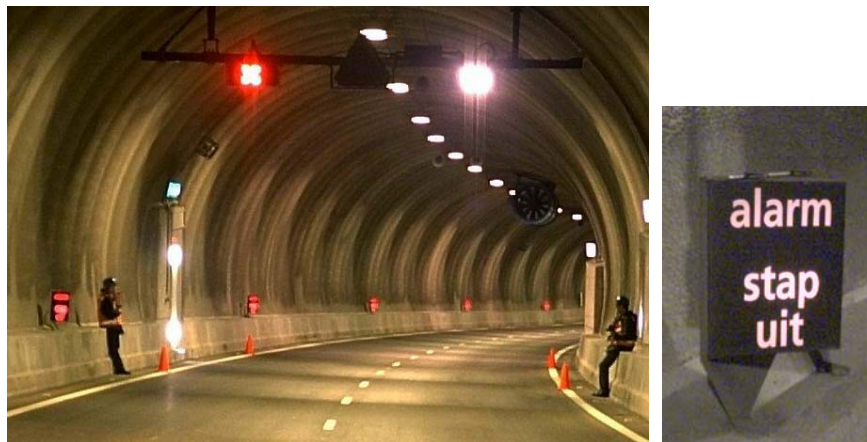
Figuur 1 – Alarmborden in de Westerscheldetunnel, speciaal voor de foto aangezet. Op de foto links zijn het de “rode blokjes” op heuphoogte; de rechterfoto is een close-up. De borden gaan aan bij ontruimingsnoodzaak.
