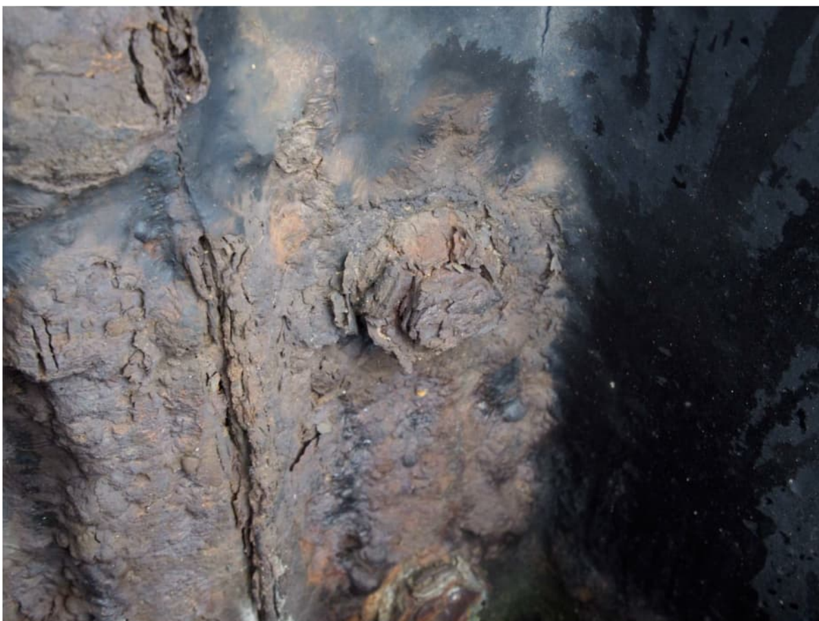
Figuur 3: Door corrosie aangetaste moer, oostzijde
