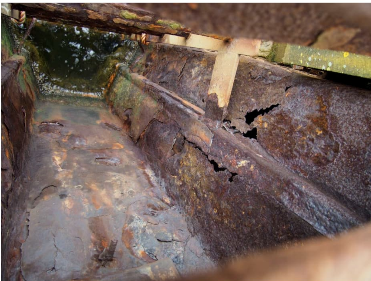
Figuur 4: Voorbeeld van de sterk door corrosie aangetaste damwand bij BiKa 2-1
