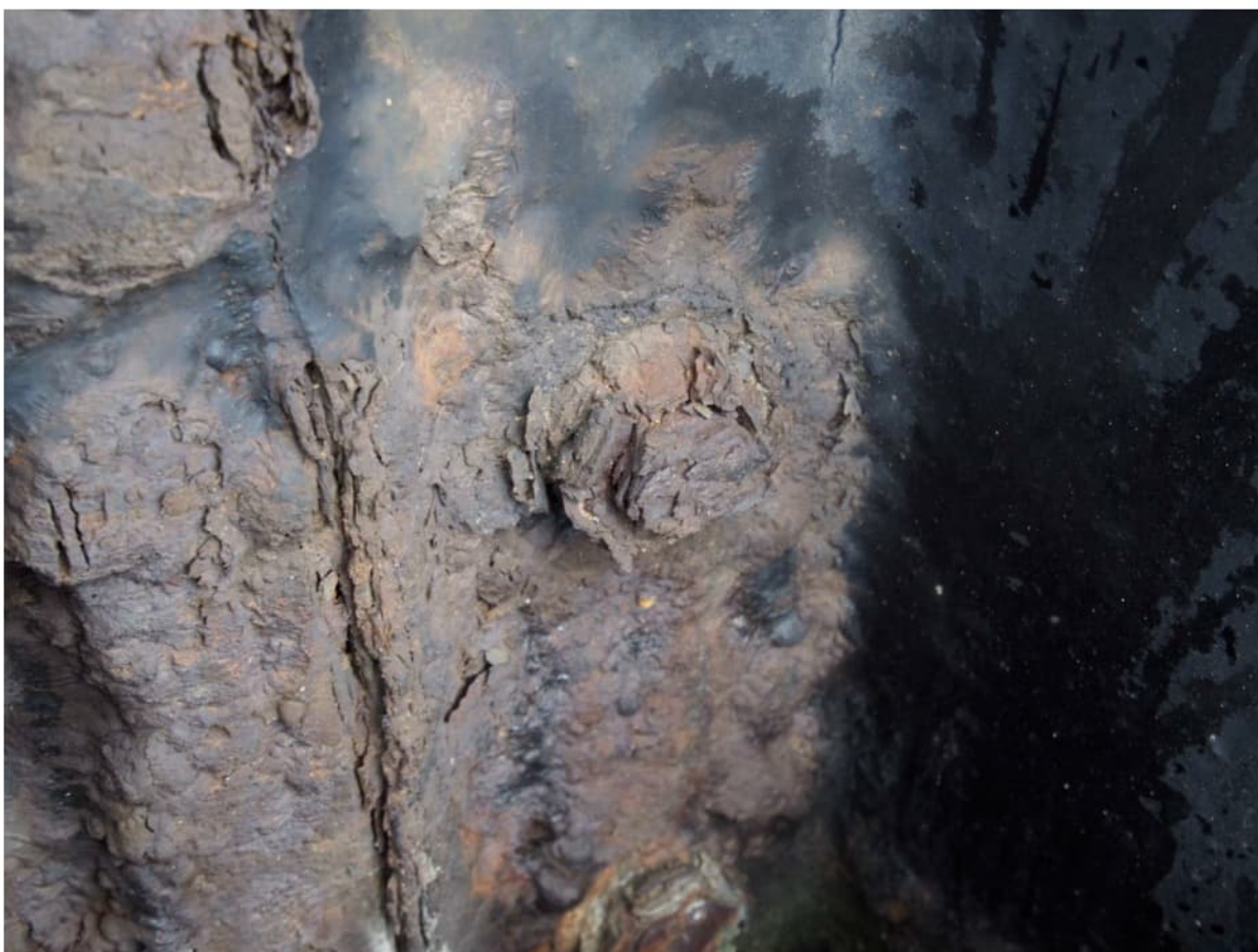
Figuur 3: Door corrosie aangetaste moer, oostzijde
