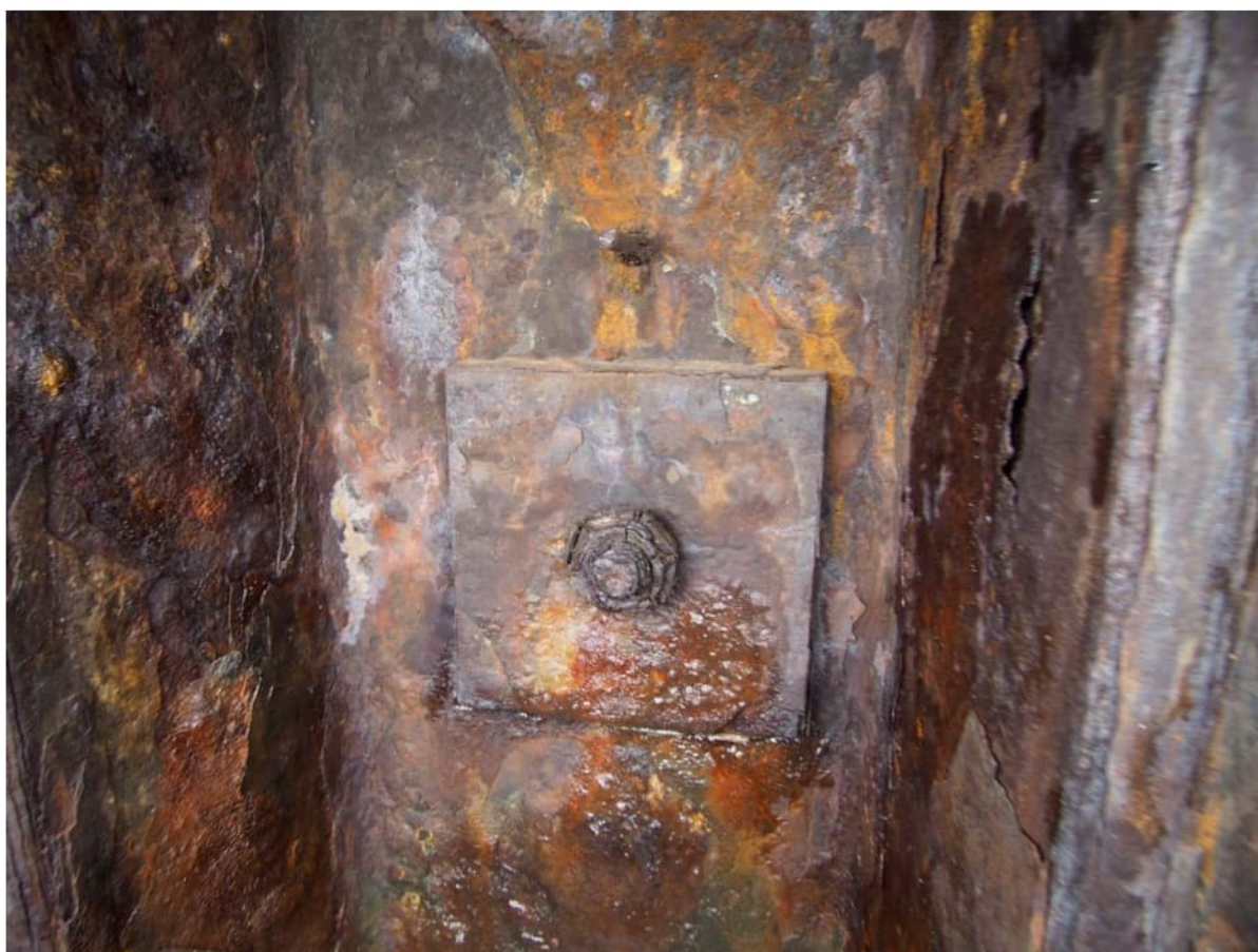
Figuur 2: Door corrosie aangetaste moer, westzijde
