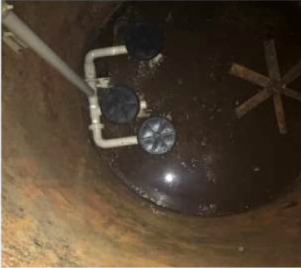
Afbeelding 2: nieuwe luchtleiding plus diffusors
