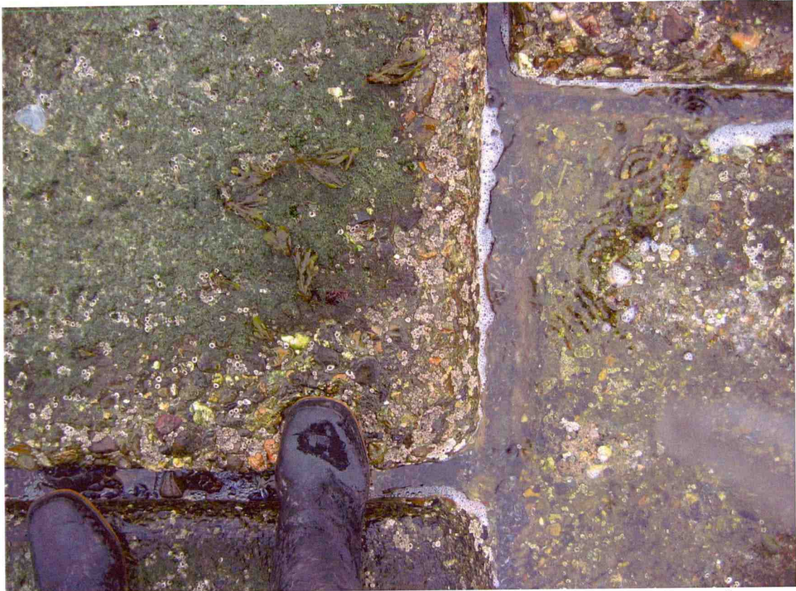
Foto 3.10. Verzakking van betonblokken (3 ton) op zeevering Westkapelle produceert vanzelf biologisch interessante poeltjes. Dit effect kan worden versterkt.
