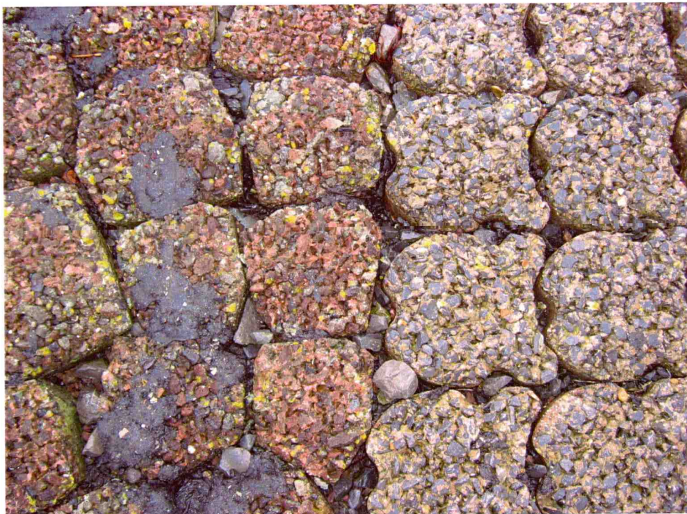
Foto 2.7. Twee typen blokken met eco-toplaag zoals gebruikt langs de Westerschelde. De blokken zijn ontworpen, door gebruik van een extra open laag van kleine stortsteen, om aangroei met wieren te versterken. De roodgekleurde blokken (links) maken gebruik van lavasteen als toplaag. De Hydroblocks (rechts) hebben een toplaag van open colloïdaal
