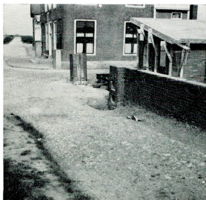
fig. 56. Dubbele coupure aan de haven te Colijnsplaat met tijdens de stormvloed van 1-2-'53 beschadigde middenpilaster.
