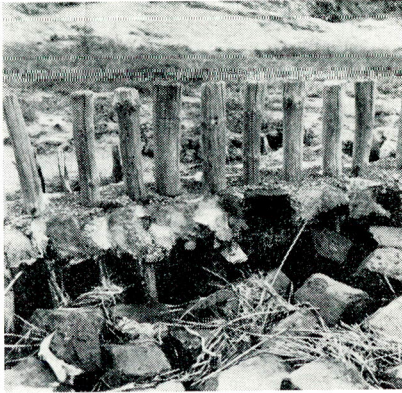
fig. 85. Nieuw Noord-Bevelandpolder. Beschadiging glooiing bij dijkpaal 2,50.
