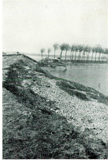
fig. 84. Jonkvrouw Annapolder. Afschuiving binnentalud bij dijkpaal 38. (Pompinstallatie pompt de polder leeg)
