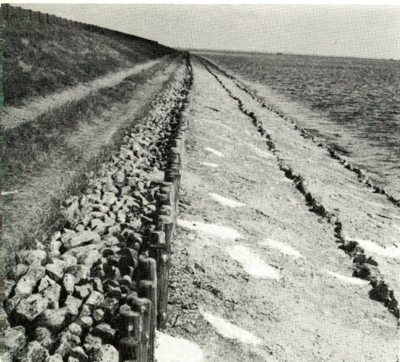
fig. 186. Glooiing van Vilvoordse steen, ingewassen met betonspecie aan de Schakerloopolder op Tholen.
