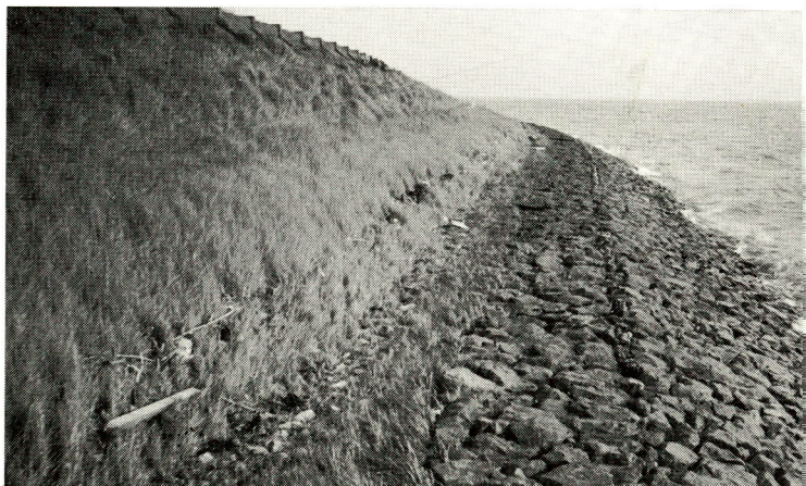
fig. 185. Zeedijk zonder buitenberm aan de zuidkust van Duiveland met glooiing van Lessinese steen.
