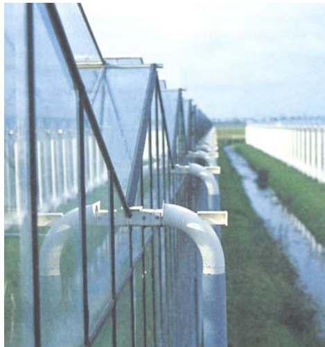
Figuur 1 – Hemelwaterafvoer: In de huidige kassen wordt al het regenwater opgevangen en afgevoerd naar een bassin.
