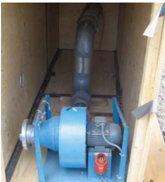
ingebouwde ventilator en meetflens
