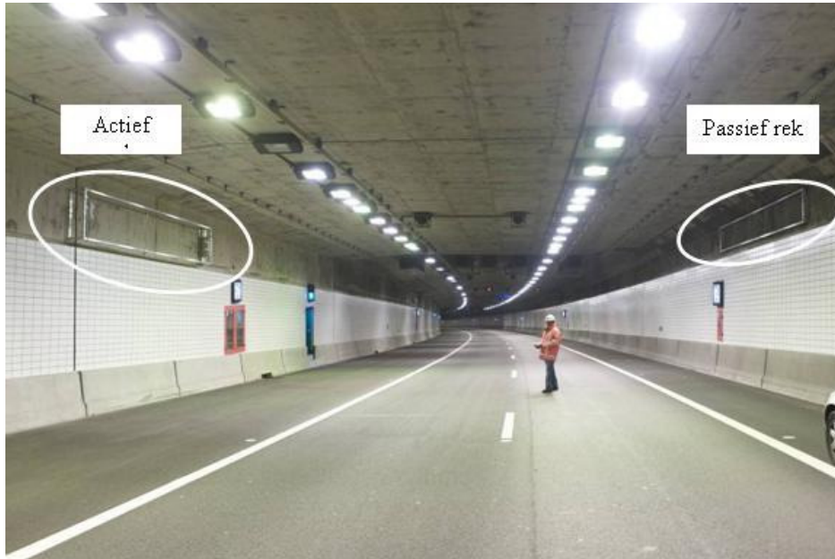
Figuur 16: Foto van de Thomassentunnel met daarin links het actieve rek en rechts het passieve rek gemonteerd.
