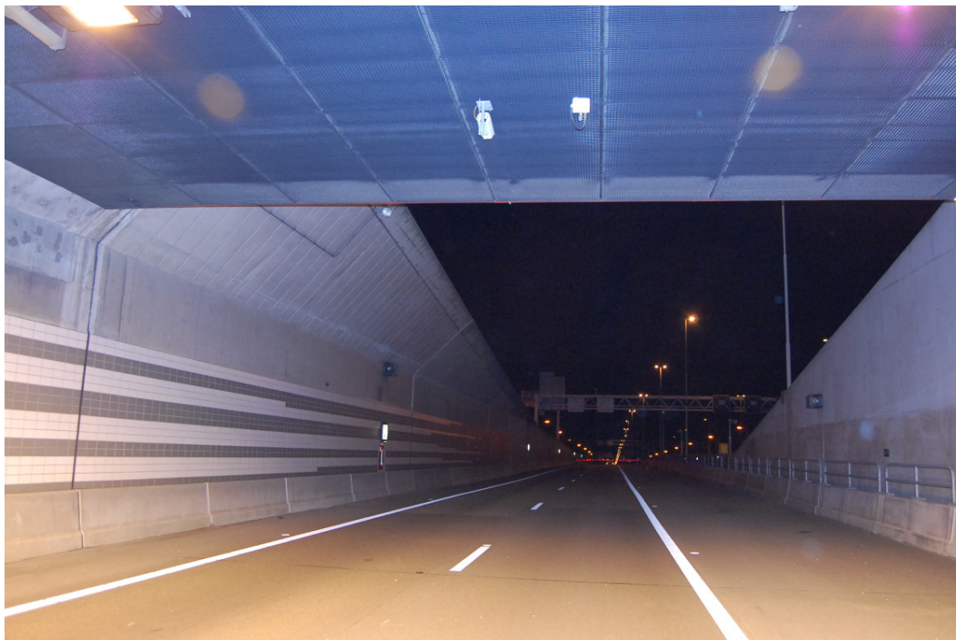
Figuur 15: Positie verkeerstellers aan het plafond bij de tunnelingang
