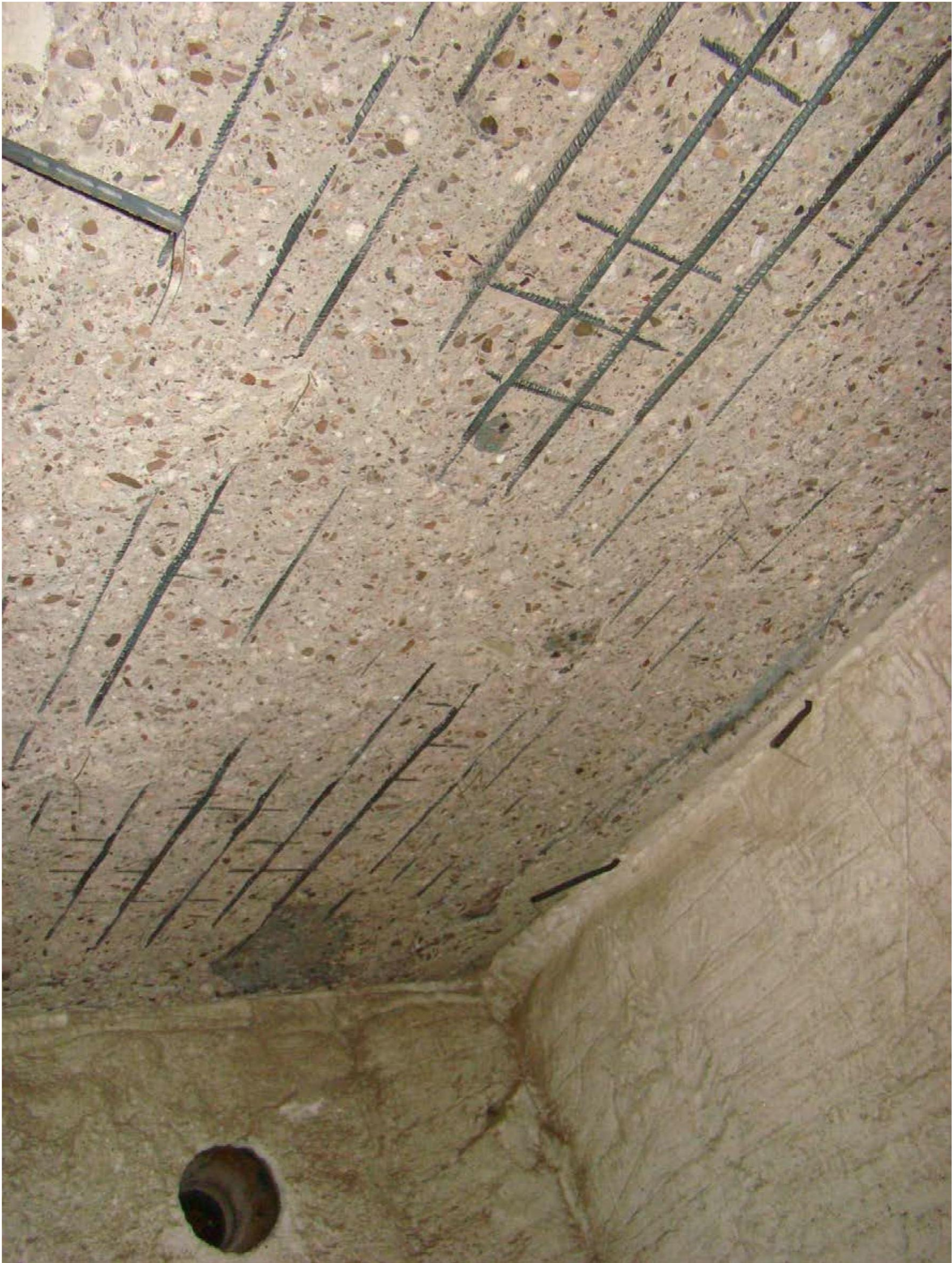
Foto 4: Verhit oppervlak na de brandproef
