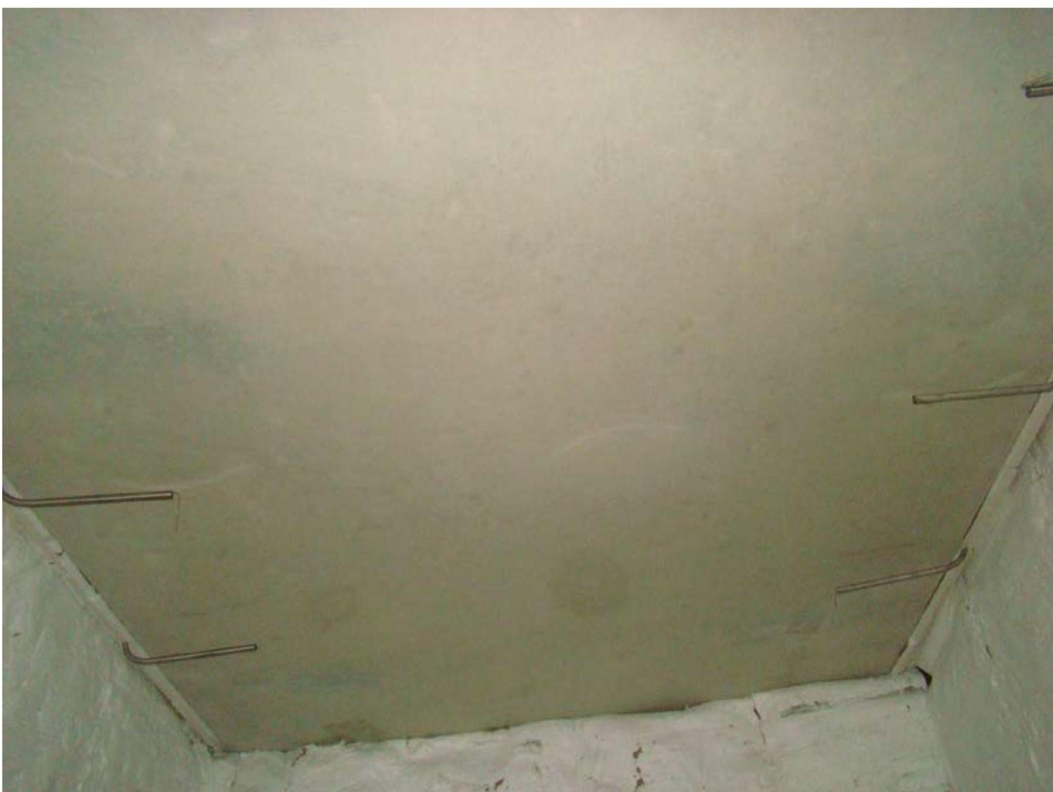
Foto 2: Verhit oppervlak voor de brandproef
