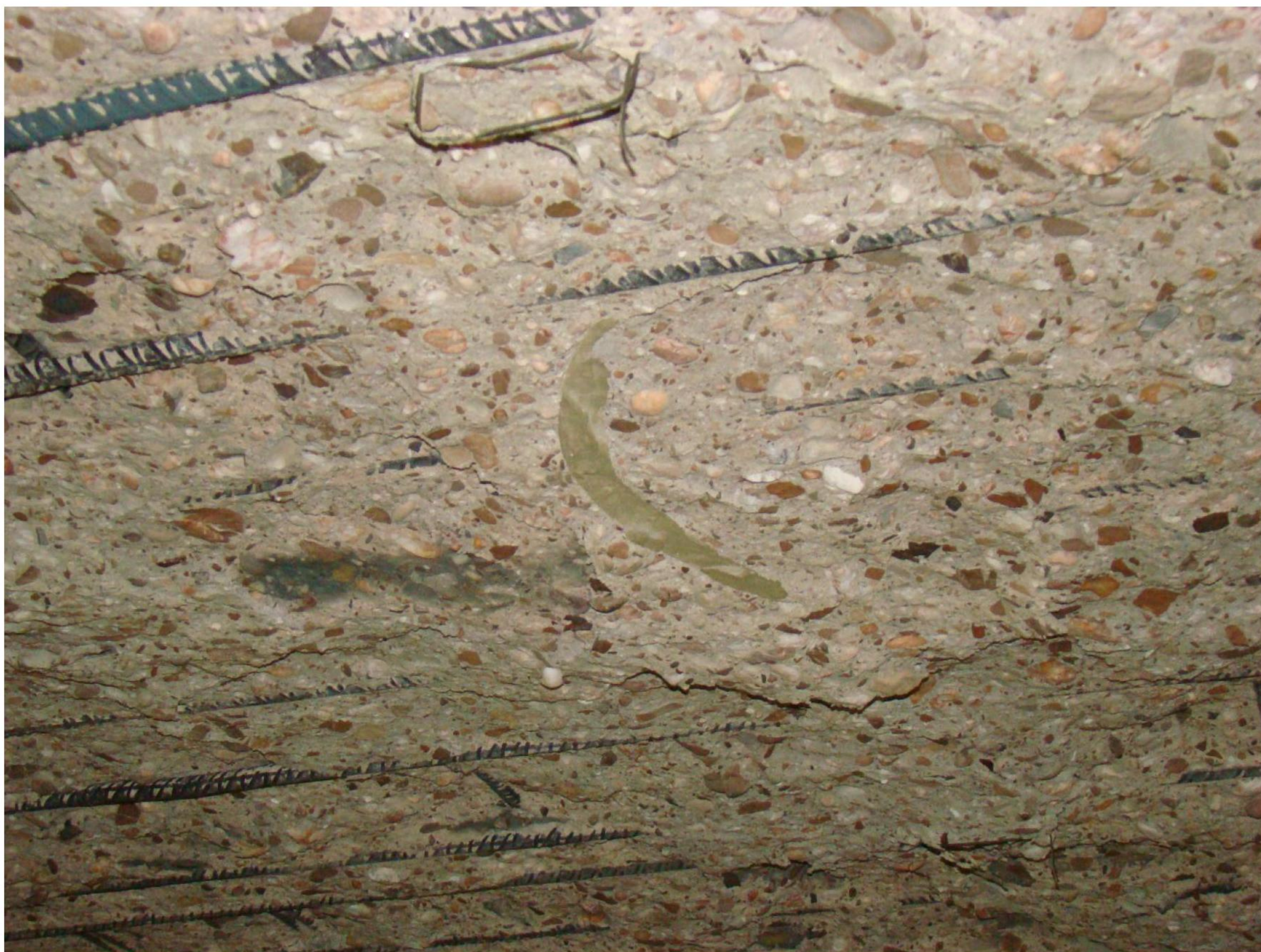
Foto 6: Details van het verhitte oppervlak na de brandproef
