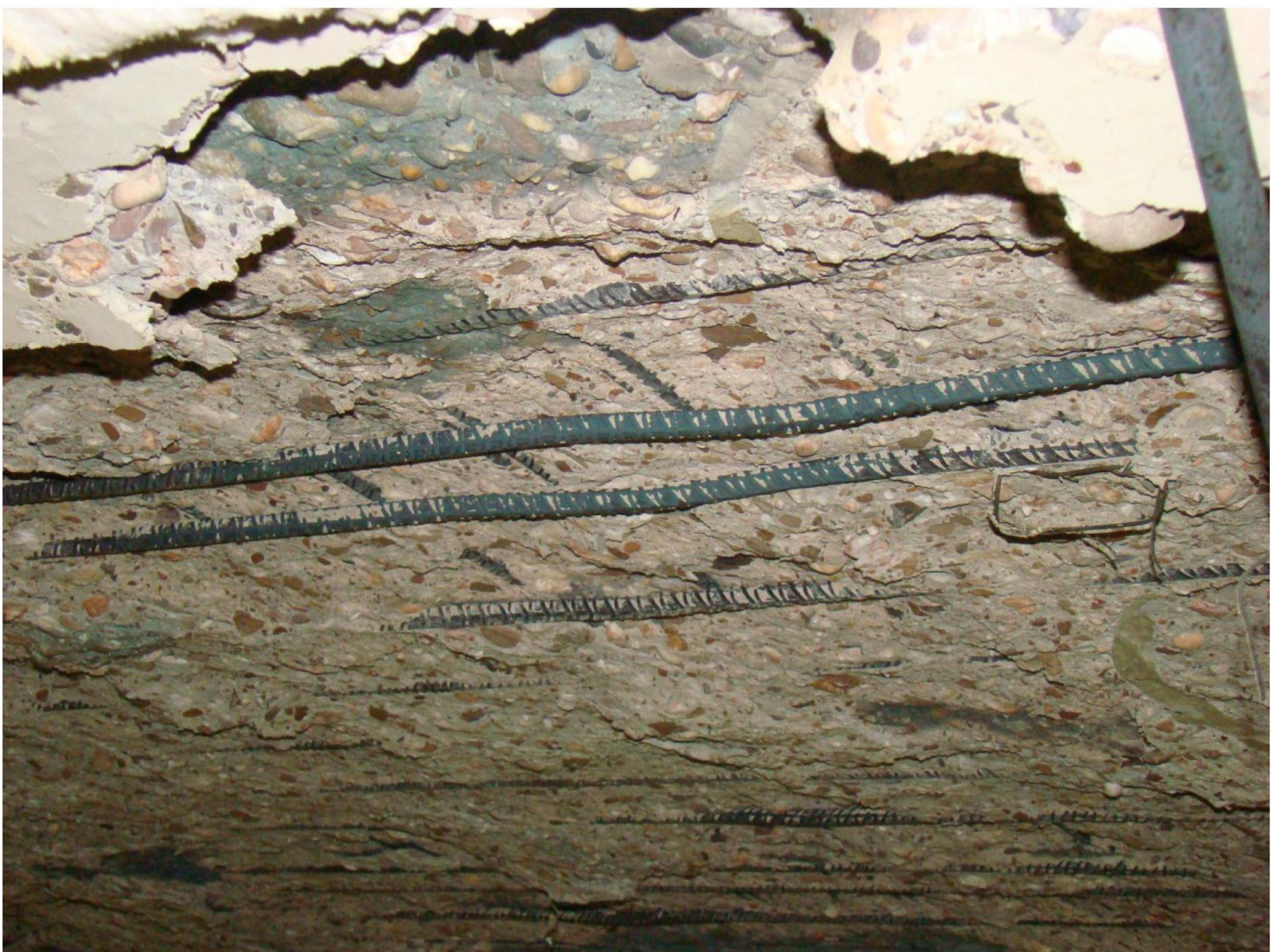
Foto 5: Details van het verhitte oppervlak na de brandproef
