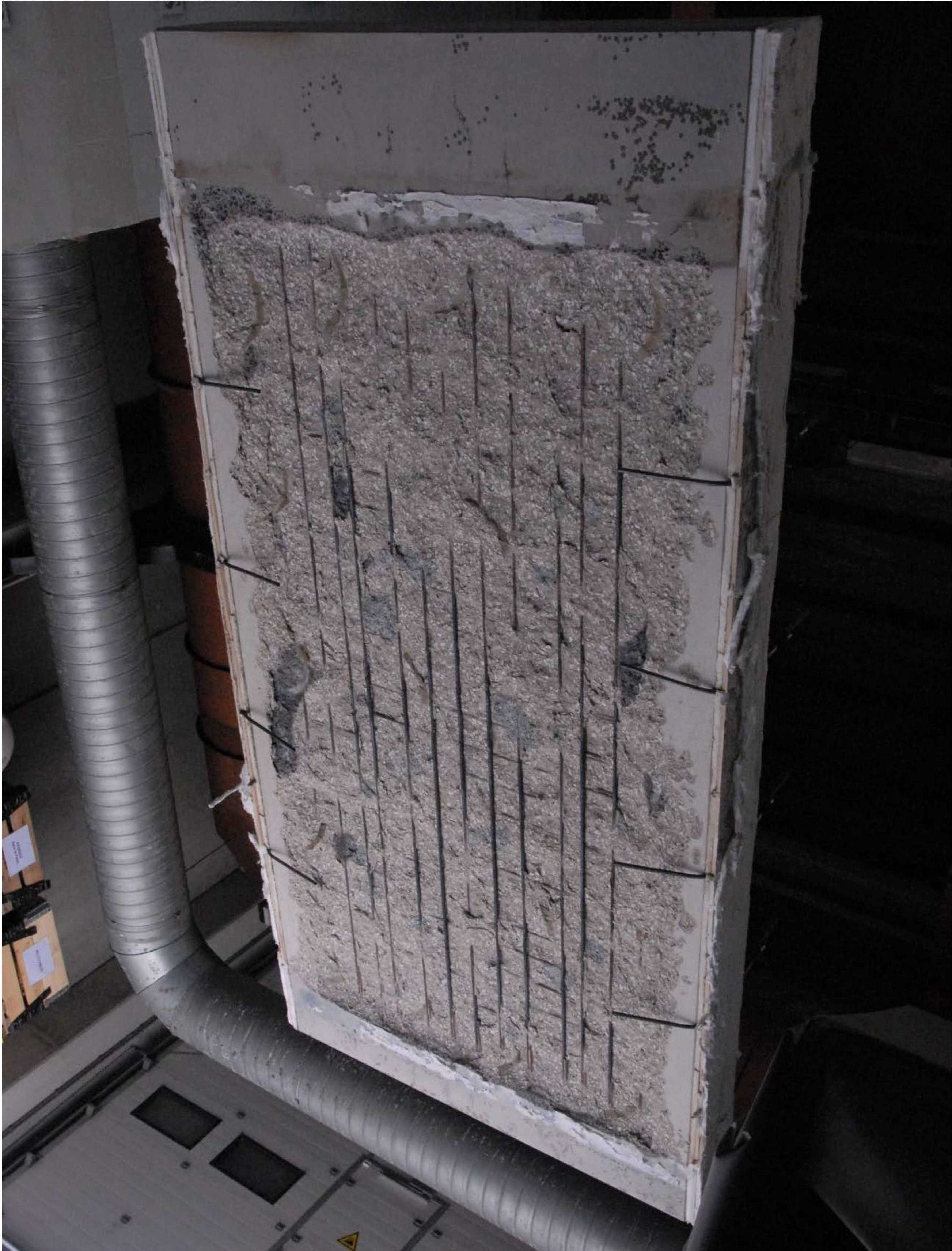
Foto 3: Verhit oppervlak na de brandproef
