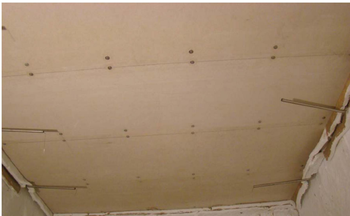
Foto 2: Verhit oppervlak voor de brandproef
