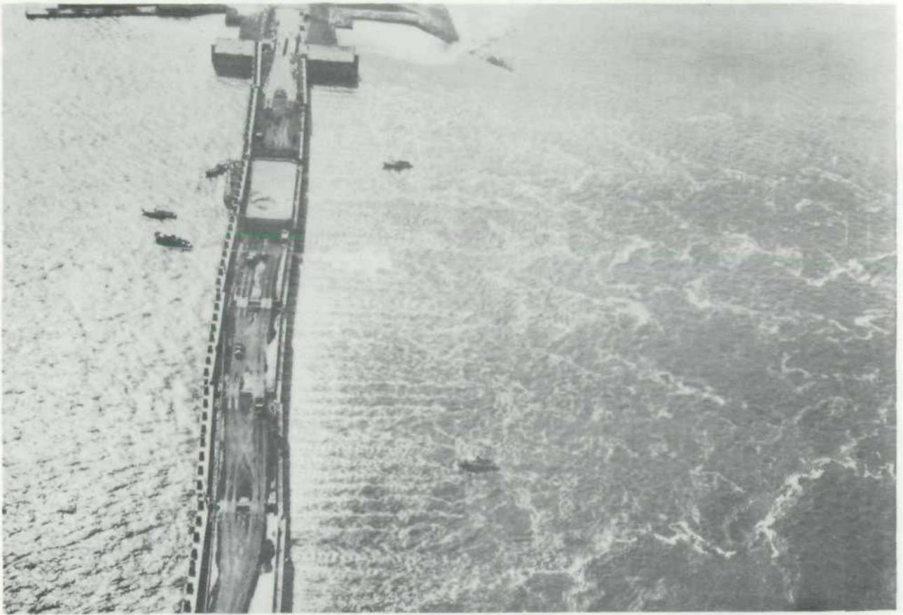
BIJLAGE IV. Veerse gat, gesloten met doorlaatcaissons. De kleppen staan nog open, zodat er nog water doorstroomt.
