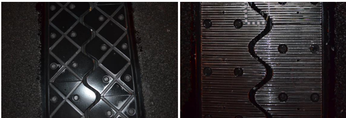
figuur 4 Detailfoto voeg 2 voor vervanging (links) en na vervanging (rechts)
