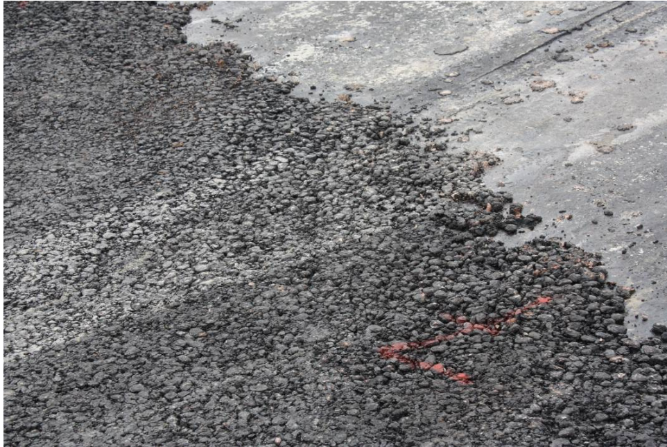
Figuur B6.1 Informatief: Te dunne laagdikte bij de rand van uitvullaag met grove steenslag (losse en verbrijzelde stenen)
