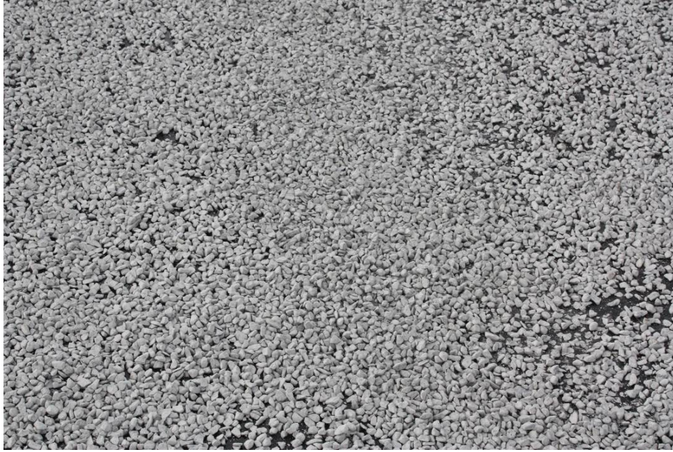
Figuur B6.6 Informatief: teveel afgestrooid membraan (volledig bedekt en deels zelfs dubbel)
