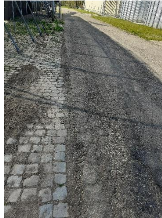
Foto 4 (10 april): Beschadigde asfaltverharding van vak 1
