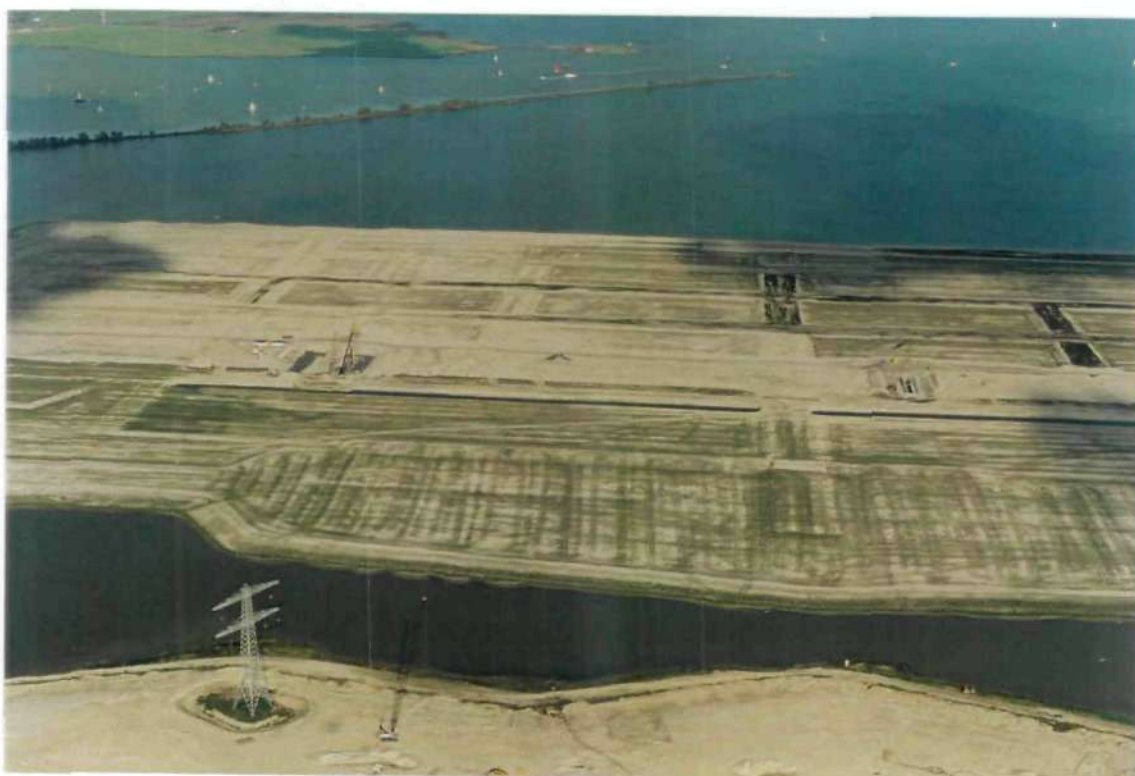
Foto 13b: Gedetailleerde opname IJburg in 2000, midden van het werkeiland, met op de voorgrond de Diemerzeedijk.
