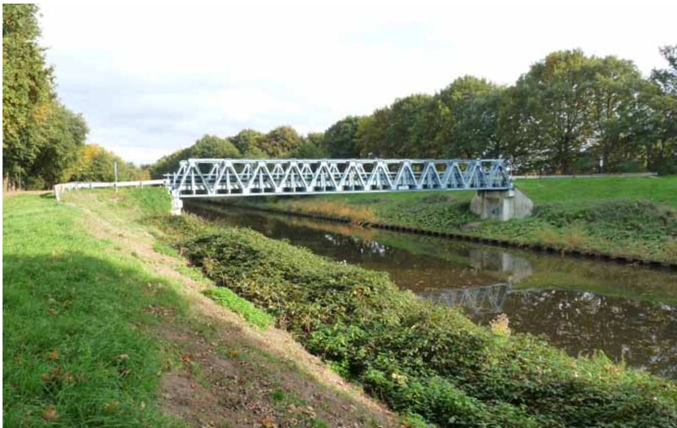
De Laarbrug bij Aarle-Rixtel is van het type Callender-Hamilton en is een object van Rijkswaterstaat ouder dan 1965 met een bijzondere cultuurhistorische waarde.
