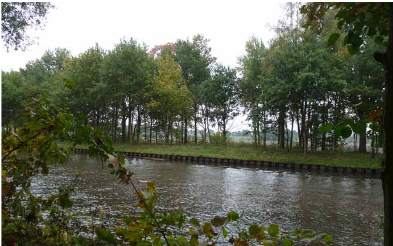
Tussen sluis IV en de westelijke zwaairom van Oirschot is het omringende maaiveld van het kanaal lager gelegen dan het kanaalpeil.
