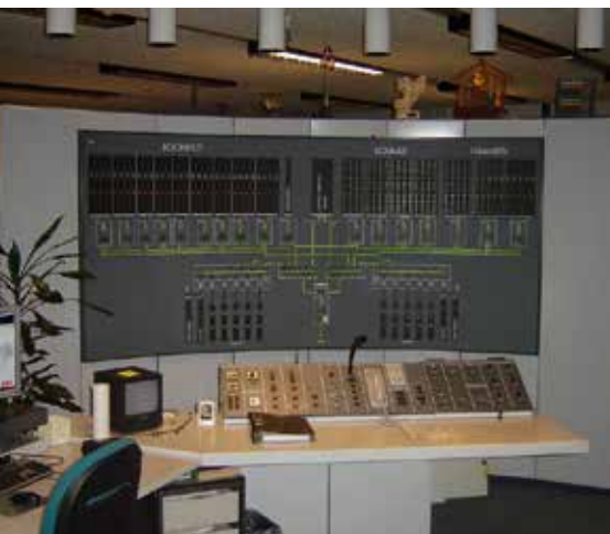
Het bedieningspaneel in de bedieningsruimte van het ir. J.W. Topshuis
