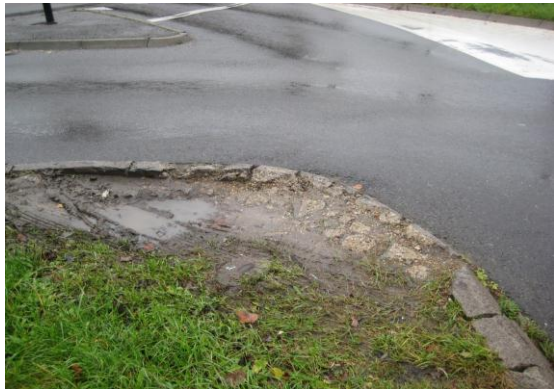
Slechte onderhoudstoestand - stukgereden trottoirbanden.
