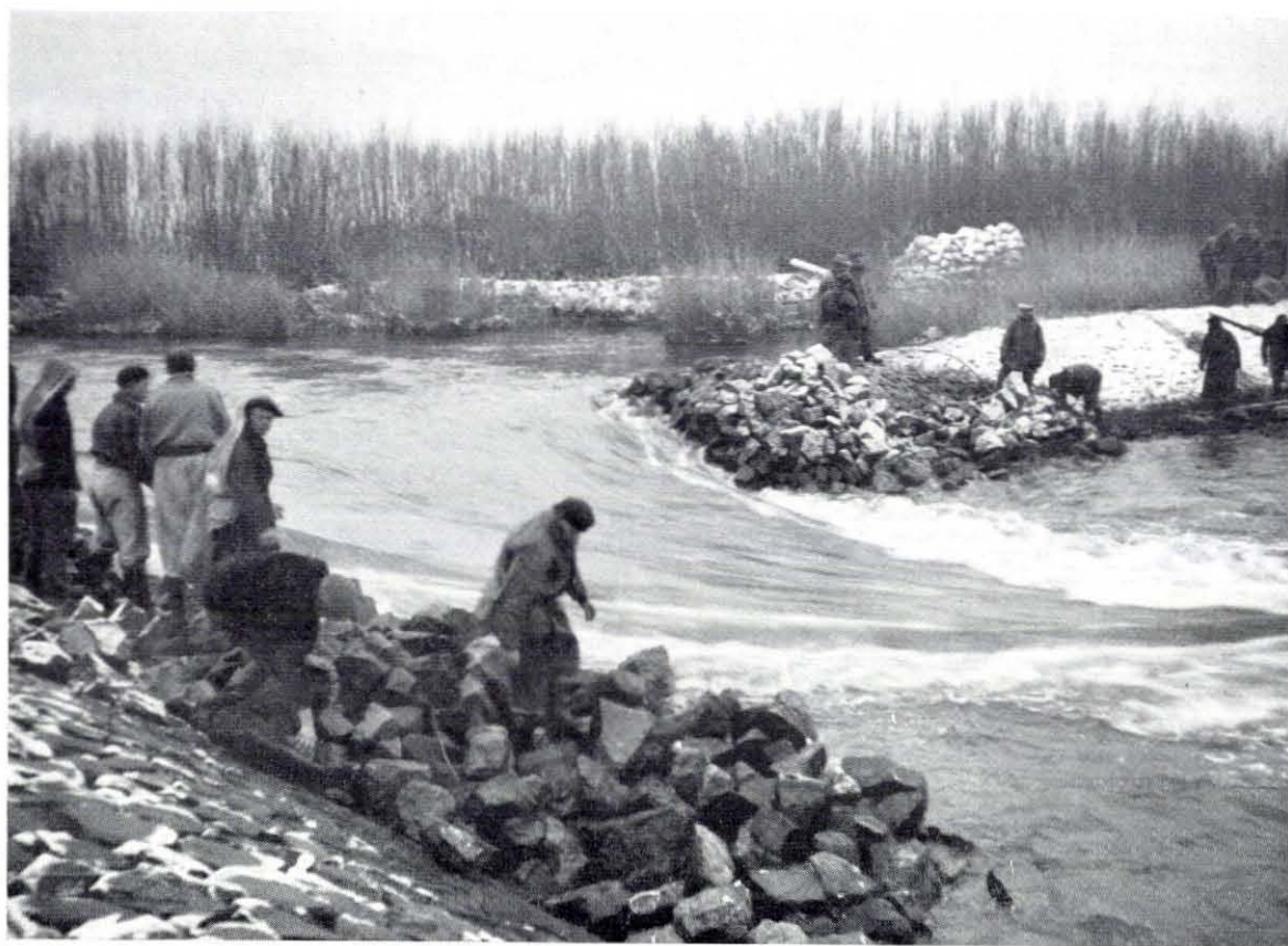
Fig. 4.203. Dichting stroomgat in de hoofdwaterkering van het Waterschap De Royale Polder ten oosten van de Moerdijkbruggen. Ebstroom over de in aanleg zijnde stenen dam in de mond van de suatiegeul van de Vegetassluis, d.d. 14 februari 1953. Foto Ir. Israël
