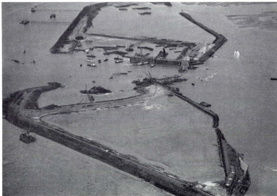
Fig. 4.123. Overzicht van het oostelijke sluitgat ten zuiden van Ouwerkerk op 6 november 1953. De sluitcaisson is reeds gemeerd achter het westelijke landhoofd. Links op de foto het Brokkengat. Foto K.L.M. - Aerocarto
