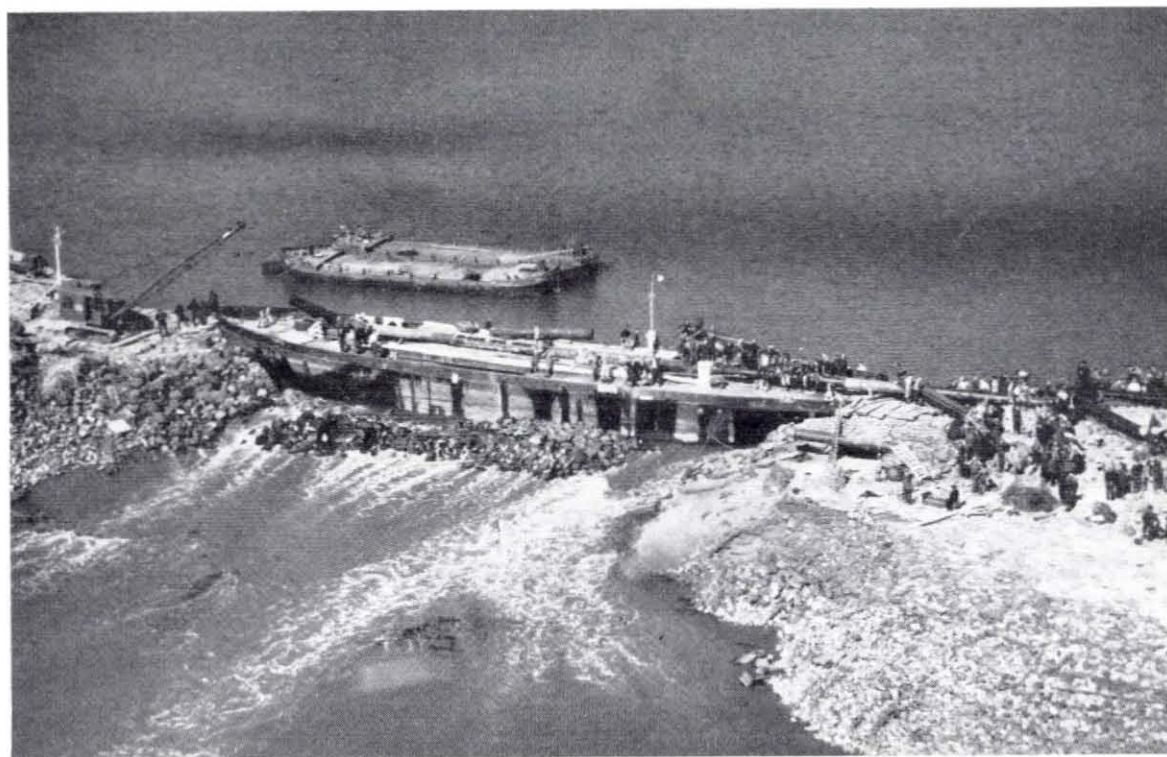
Fig. 4.150. Het door middel van een casco geblokkeerde stroomgat in de hoofdwaterkering van de Reigersbergse Polder bij Bath, d.d. 21 april 1953 Foto K.L.M. - Aerocarto
