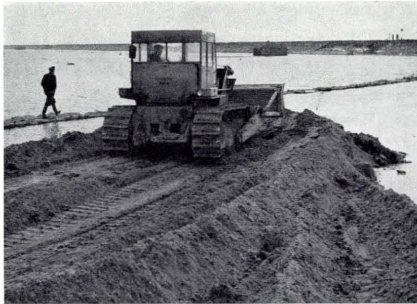
Fig. 4.61. Het dichtn van de doorbraak in de oostelijke dijk van de Rijkstramweghaven te Numansdorp. Door een bulldozer wordt het zand tussen de aangelegde kleikade en de zandzakkendam geduwd.
