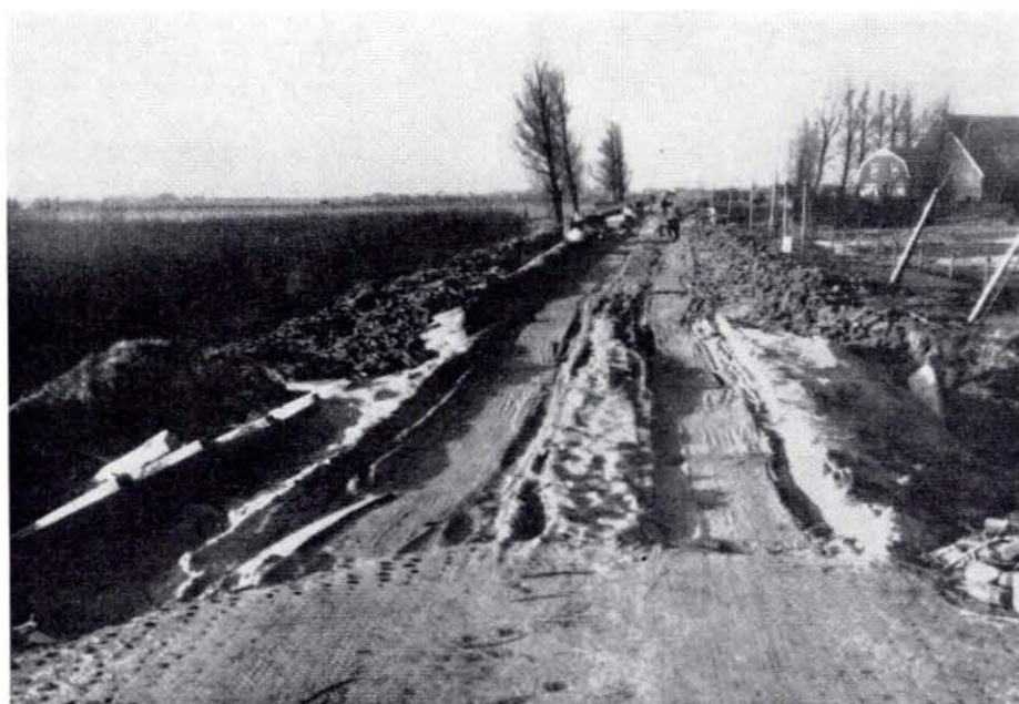
Fig. 4.66. Een gedichte doorbraak in de dijk langs de Dordtse Kil van de Oudendijkse polder. Links de omgeslagen betonnen schermwand.
