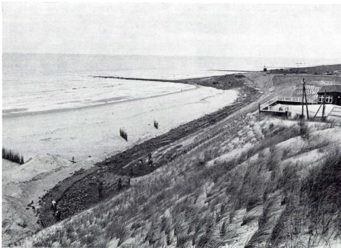
Fig. 4.30. Het herstel van de steenglooiing van de Hondsbosse Zeewering en het maken van de duinvoetverdediging tussen strandhoofd 29 en 30 te Kamperduin Foto De Jong
