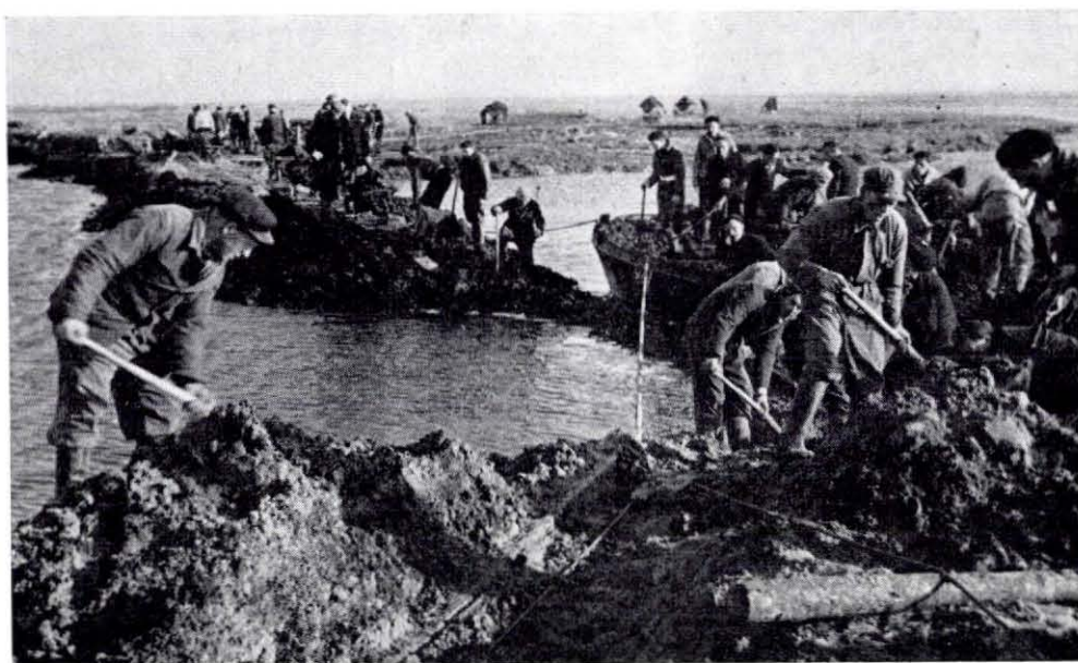
Fig. 4.26. Het dichten van de doorbraak in de hoofdwaterkering van de Polder de Eendragt op 25 februari 1953 Foto De Waal
