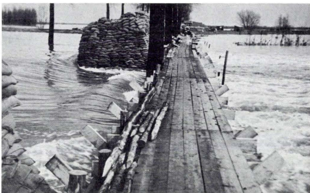
Fig. 4.157. Pijlers van zandzakken met loopsteiger in het sluitgat op de rijksweg ten behoeve van sluiting Kadijk Foto Kruithof
