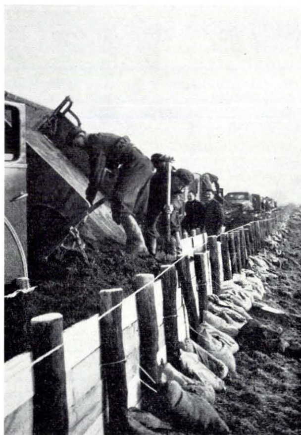
Fig. 4.56. Het aanbrengen met behulp van kipauto's van de kleivulling in de kistdam op de westelijke kade van het Kanaal door Voorne
