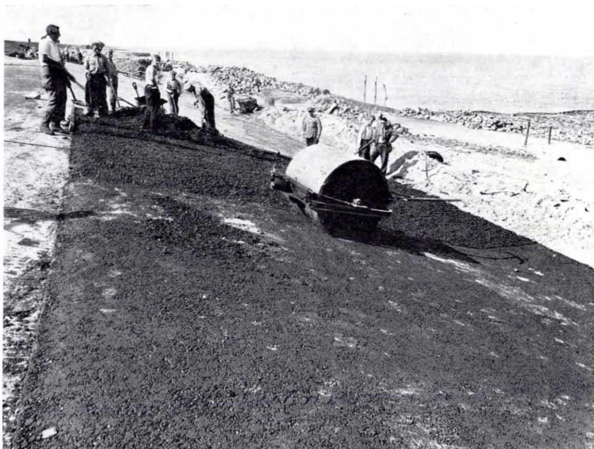
Fig. 4.82. Spreiden van de 10 cm dikke laag asfaltbeton en inwalsel loodrecht op de kruin van de dijk
