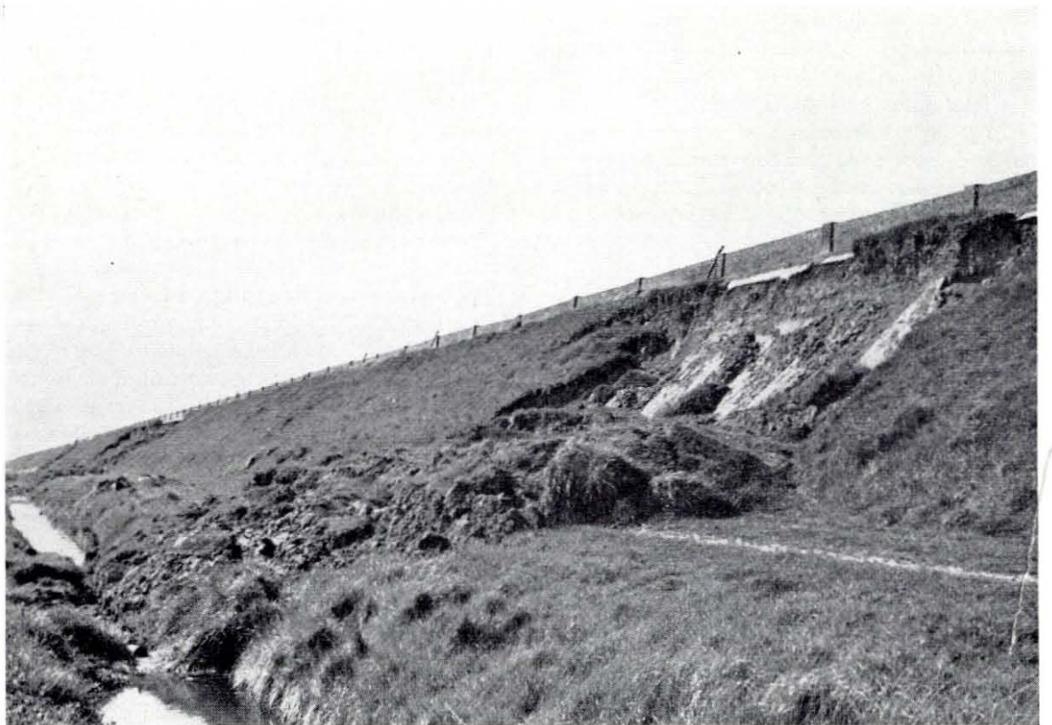
Fig. 3.5. Noordelijke dijk van de polder Nieuw-Bommenede, oostelijk deel. Plaatselijke beschadigingen van het binnentalud; daartussen is het binnentalud geheel gaaf.
