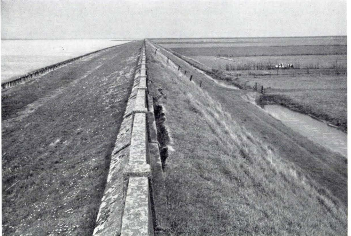
Fig. 3.4. Langsscheuren in de dijk van de polder Nieuw-Bommenede.
