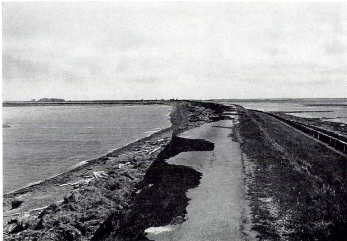
Fig. 3.8. Dijk van de polder Vierbannen van Duiveland, ten oosten van de stroomgaten van Ouwerkerk. Beschadiging van het binnentalud. Op de kruin een asfaltbetonverharding.
