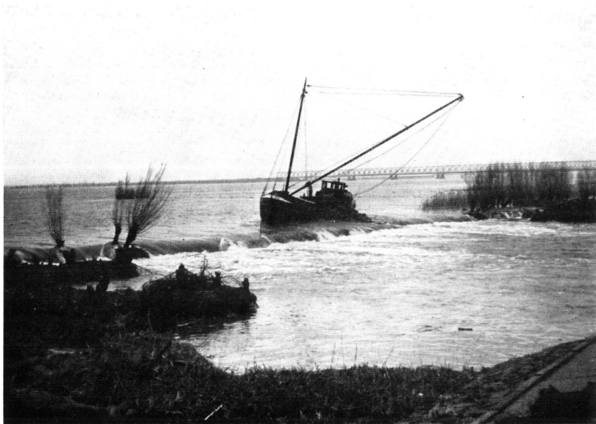
Fig. 4.204. Het storten van steen op de intact gebleven rug van de oeververdediging in het stroomgat ten noorden van Moerdijk, d.d. 9 februari 1953
