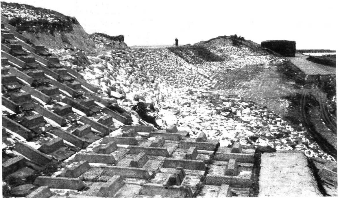
Fig. 4.183. Noodherstel aan de Westkapelse zeewering tussen dp. 38 en strandpaal 1 van de Noordwatering
