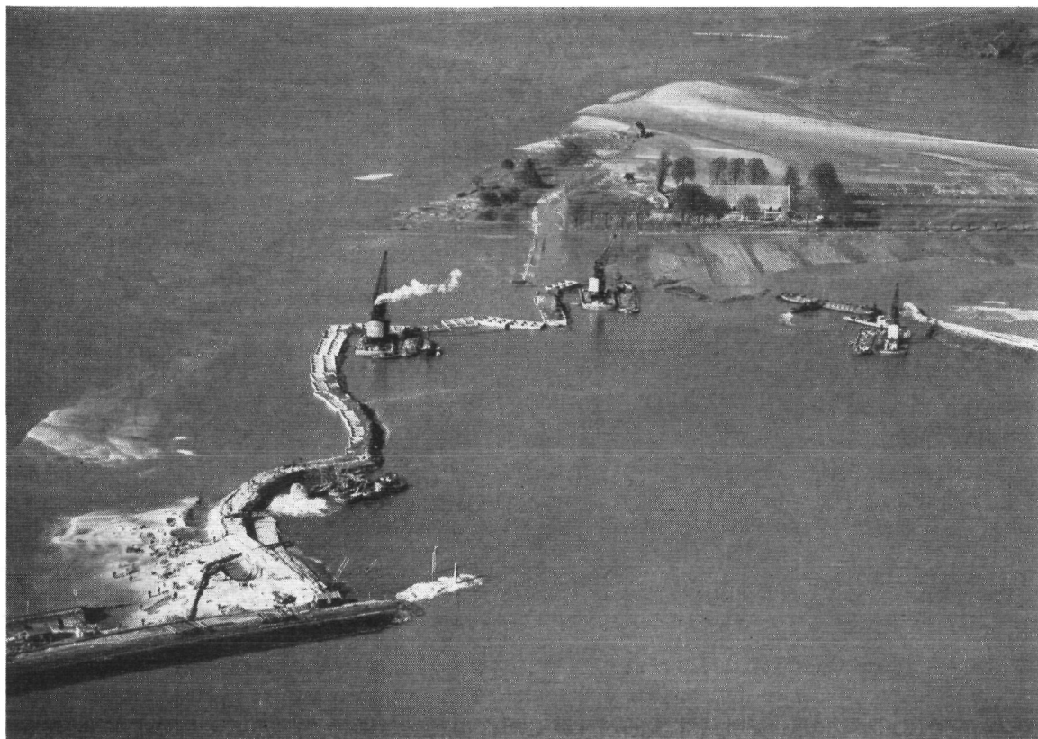
Fig. 4.163. Het maken van de inlaagkade bij het oostgat in de hoofdwaterkering van het Waterschap Kruieningen. De geplaatste elementen worden met behulp van drijvende kranen met Boomse klei gevuld. Op de achtergrond de boerderij „Den Inkel”. Foto K.L.M. - Aerocarto
