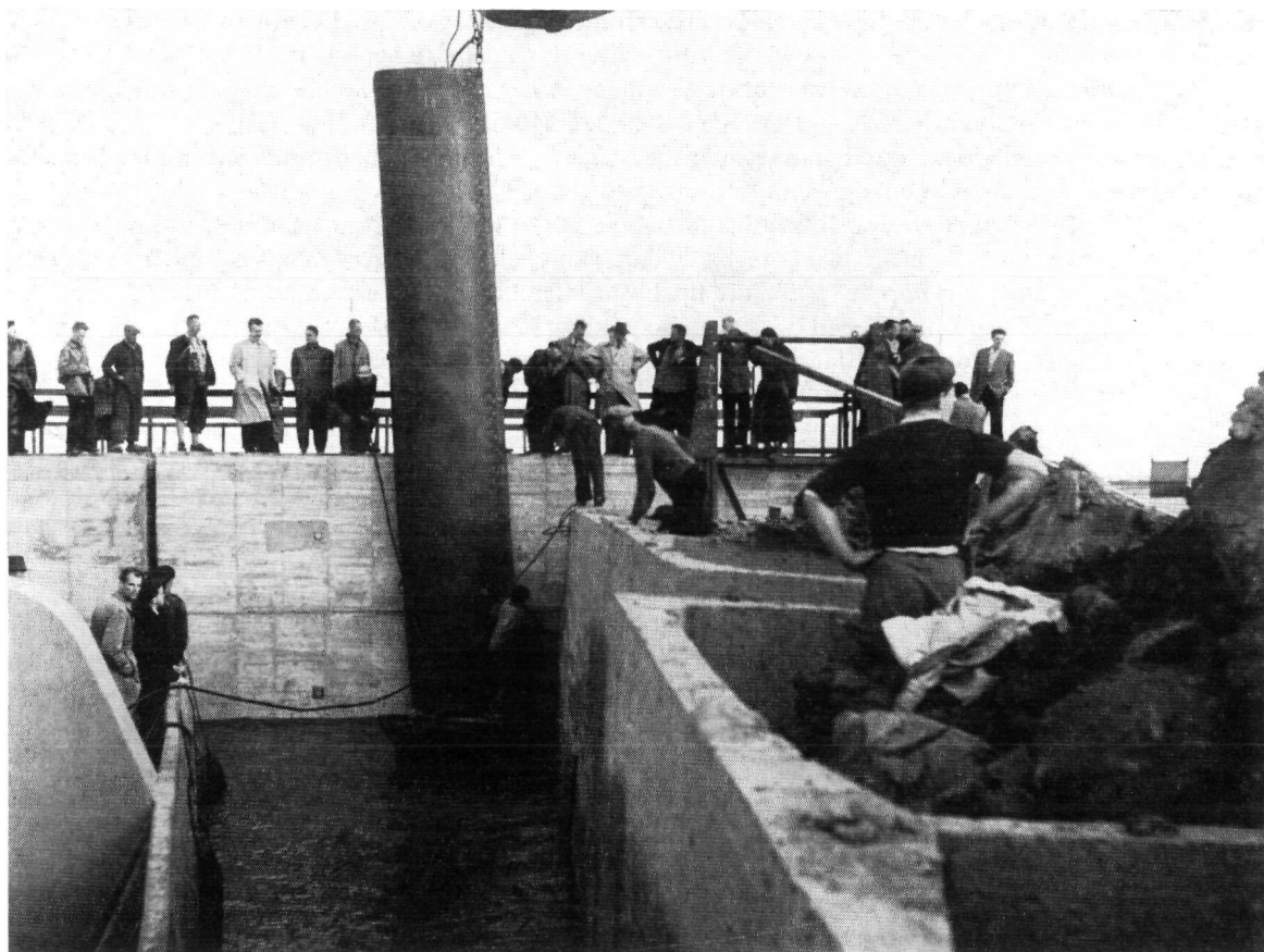
Fig. 4.166. Aanbrengen van een rubberworst voor afdichting tussen de aanslagen van de westelijke sluitcaisson en de pijlercaisson bij de blokkering van het gat bij de Veerhaven te Kruiningen op 23 juli 1953 Foto Stuvet
