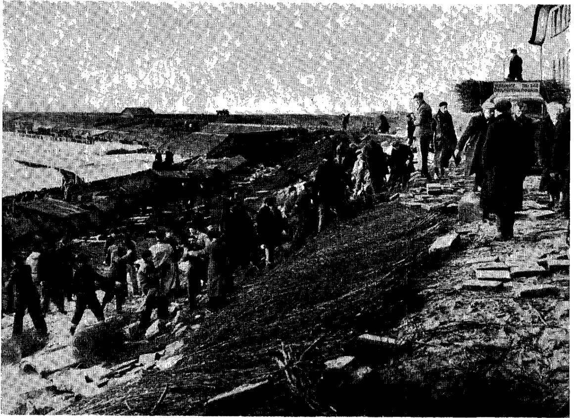
Fig. 4.182. Aanbrengen noodbeslag op de zwaar beschadigde Nolledijk tussen dp. 10 en 12 van de Westwatering te Vlissingen
