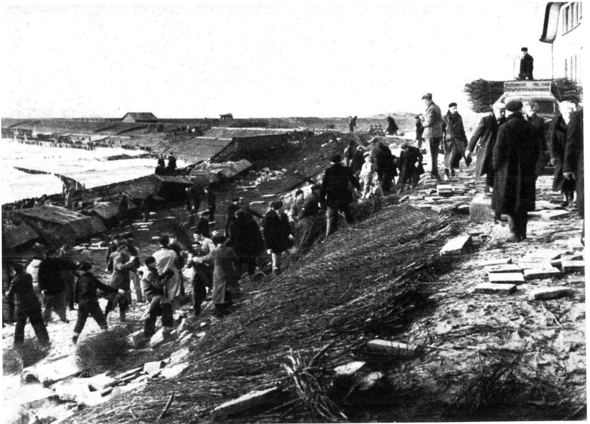
Fig. 4.182. Aanbrengen noodbeslag op de zwaar beschadigde Nollendijk tussen dp. 10 en 12 van de Westwatering te Vlissingen
