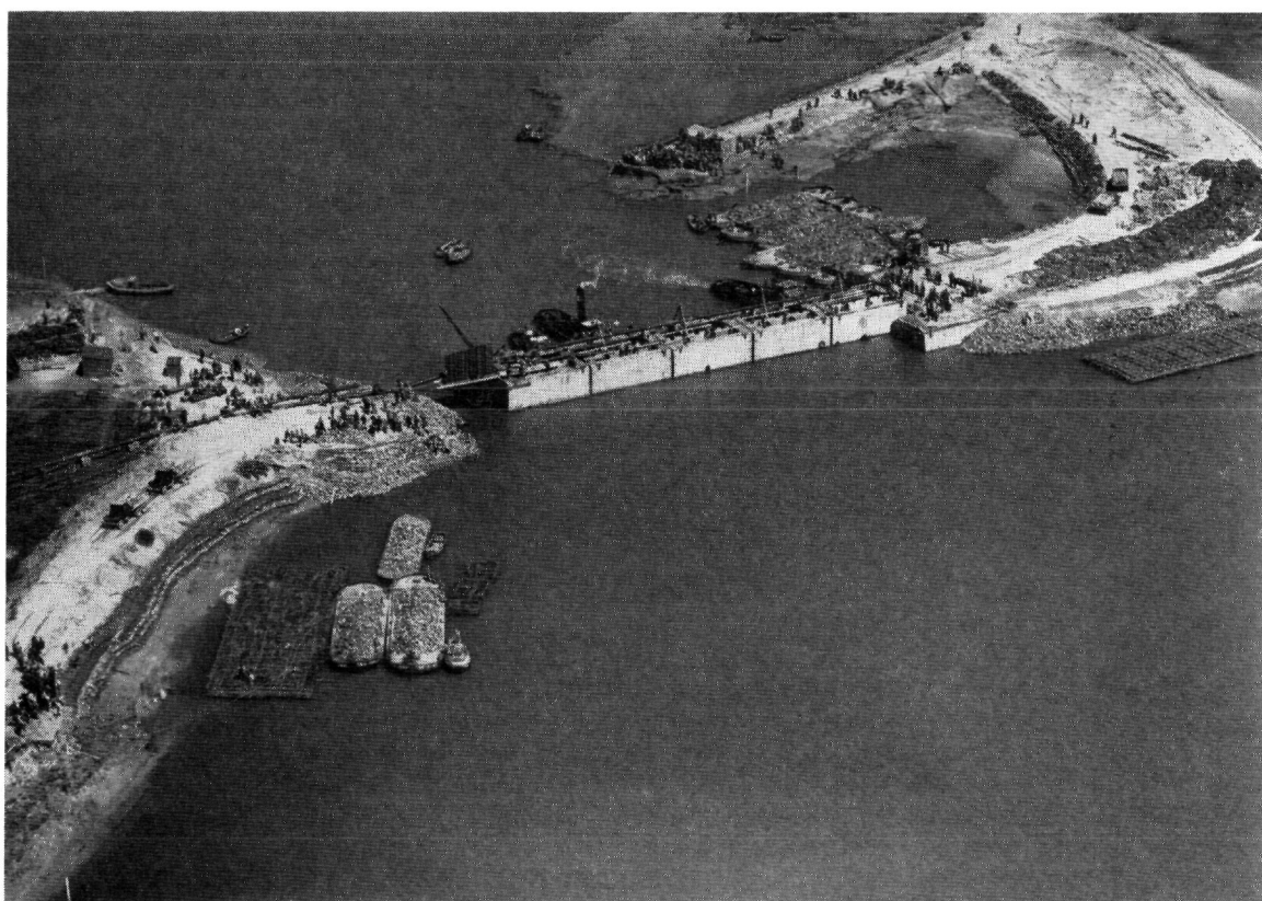
Fig. 4.108. Het zinken van de eenheidscaisson voor de blokkering van het stroomgat bij Stevensluis op 28 juli 1953. De stalen balken van de guillotine zijn nog niet gevallen. Zinkstukken en bakken met steen liggen aan binnen- en buitenzijde gereed voor gebruik na de blokkering. Foto K.L.M.-Aerocarto
