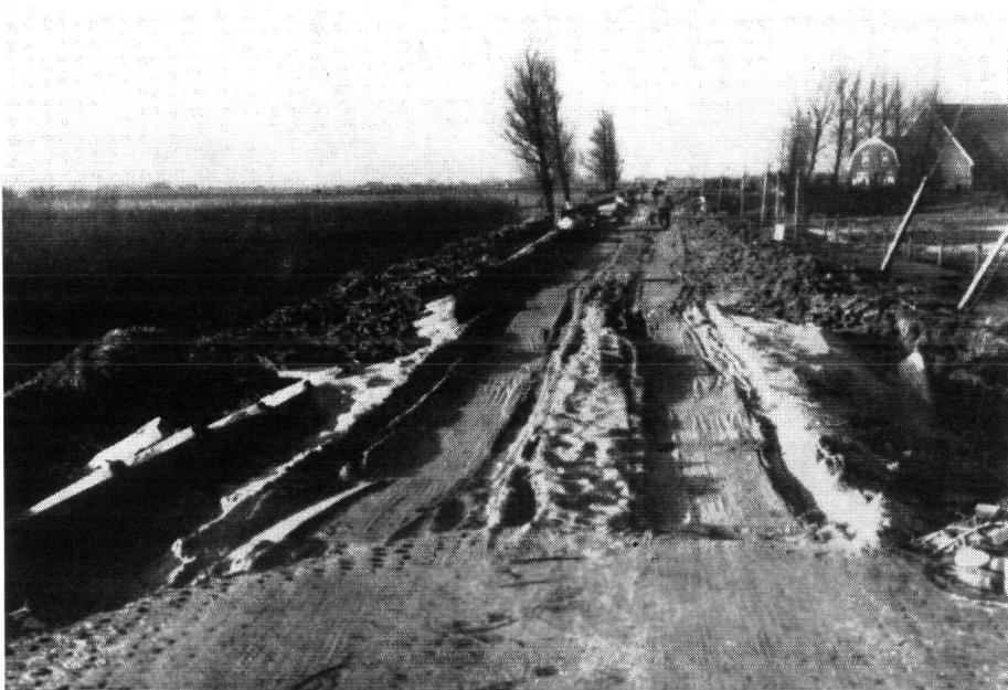
Fig. 4.66. Een gedichte doorbraak in de dijk langs de Dordtse Kil van de Oudendijkse polder. Links de omgeslagen betonnen schermwand.
