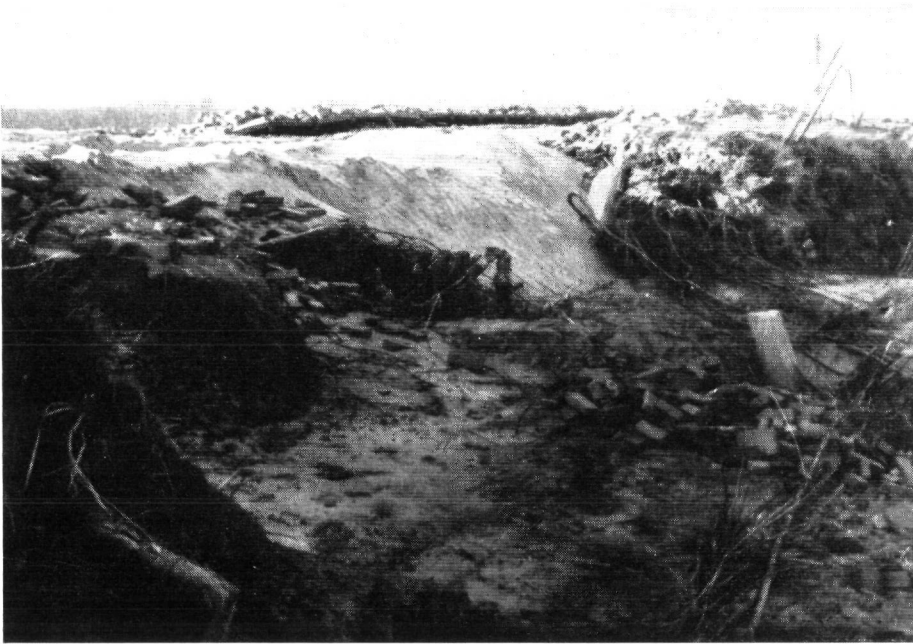
Fig. 4.65. Met zand gedichte doorbraak in de dijk langs de Dordtse Kil van de Oudendijkse polder. Op de achtergrond de omgeslagen betonnen schermwand. Op de voorgrond weggeslagen stenen uit de oude rijksweg.
