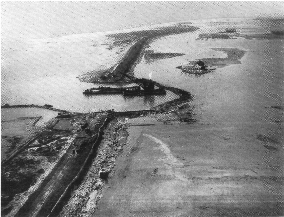
Fig. 4.112. Het aanbrengen van klei op de stenen dam, waarmee het grote stroomgat in de zuidelijke hoofdwaterkering van het Waterschap Ooster- en Sirjansland werd afgesloten, d.d. 21 mei 1953 A.N.P.-foto
