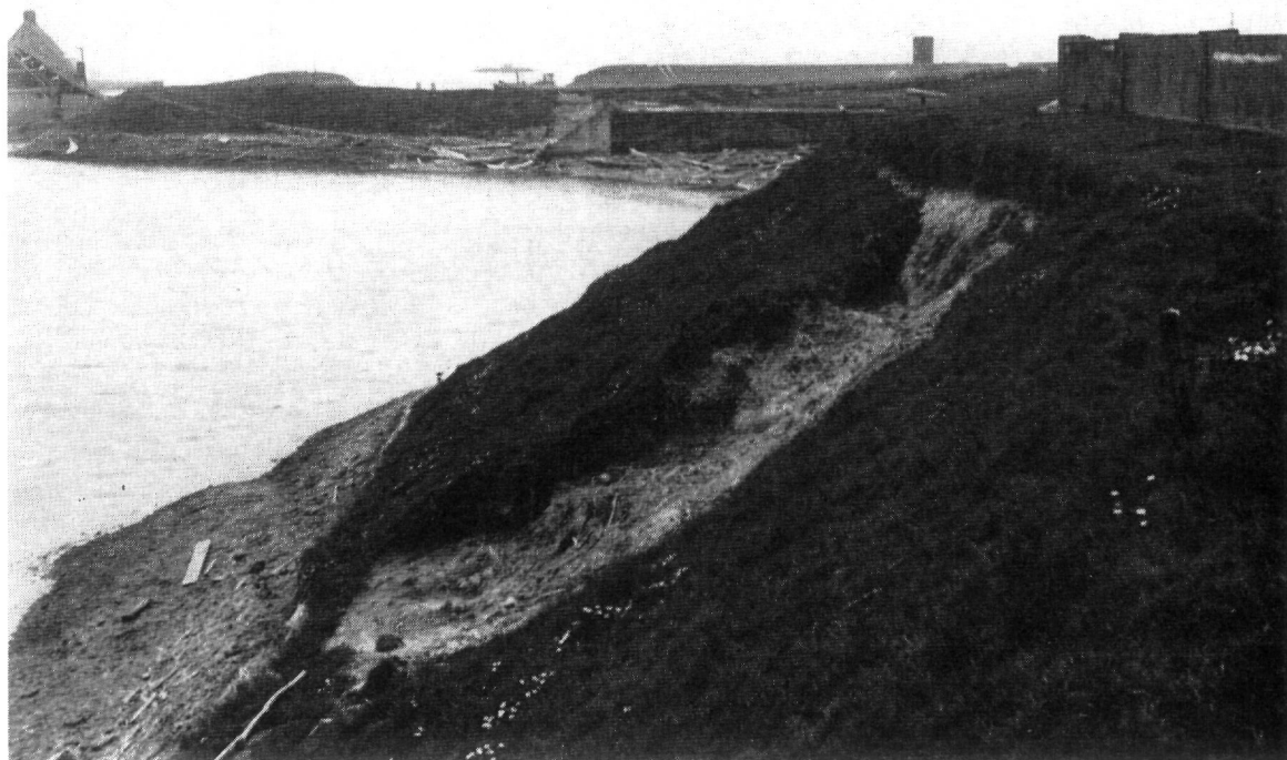
Fig. 3.6. Zuidelijke dijk van Schouwen, tussen de havenmond van Zierikzee en de Cauwersinlage. Afschuiving in het binnentalud, met aansluitende langsscheur. De binnenteenlijn is niet mede afgeschoven.
