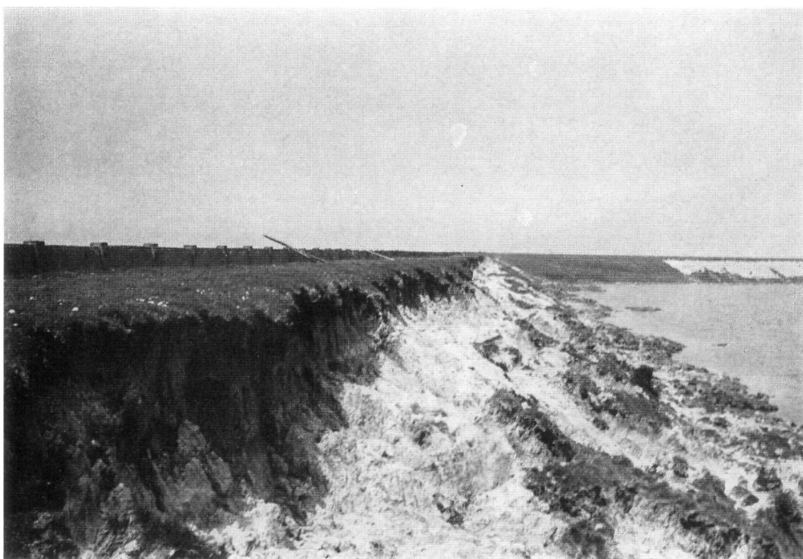
Fig. 3.7. Dijk langs de Cauwersinlage op Schouwen. Aaneengesloten verwoesting van het binnentalud.
