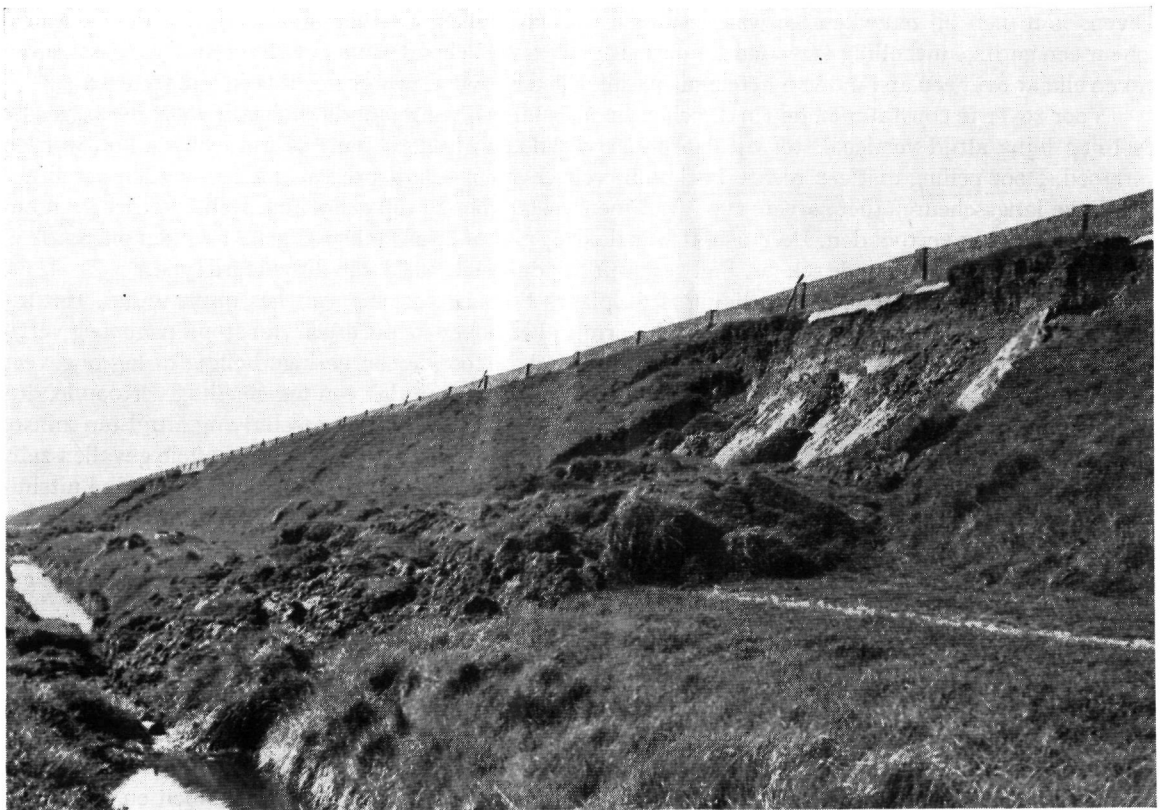
Fig. 3.5. Noordelijke dijk van de polder Nieuw-Bommenede, oostelijk deel. Plaatselijke beschadigingen van het binnentalud; daartussen is het binnentalud geheel gaaf.
