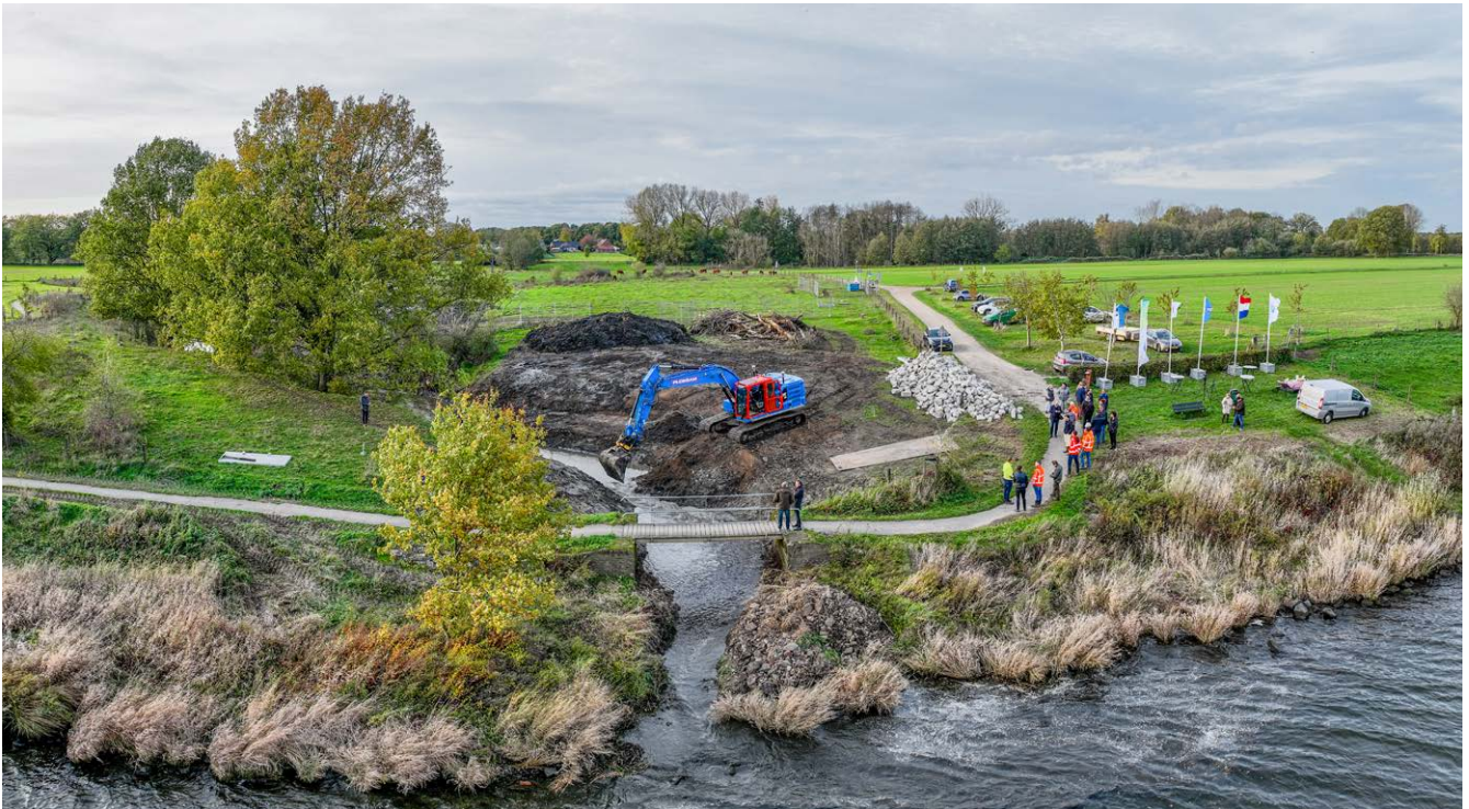
Werkzaamheden aan de Molenbeek van Lottum ten behoeve van vismigratie. Waterschap Limburg is initiatiefnemer van dit beekproject en werkt samen met Rijkswaterstaat aan het verbeteren van de uitmonding in de Maas | Waterschap Limburg
