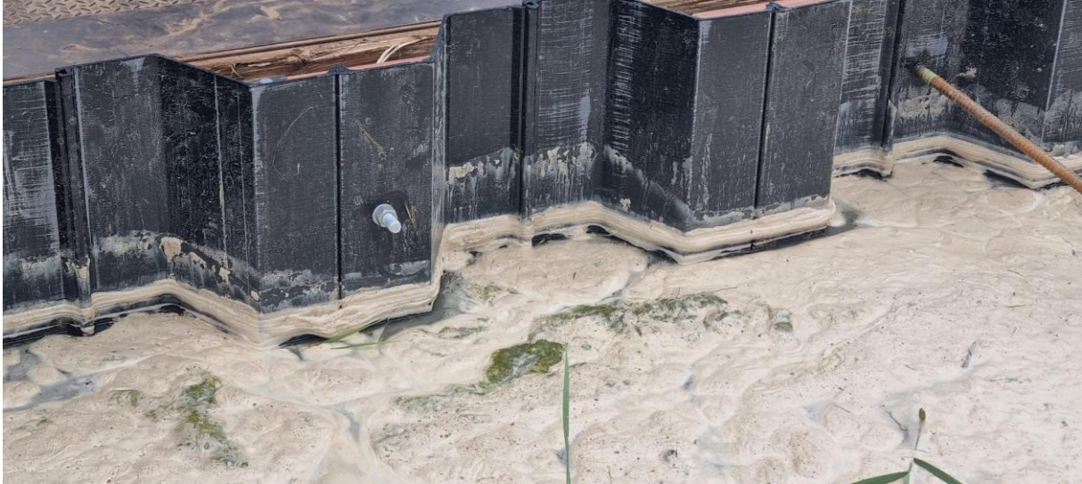
Figuur 22 - Afdichting verkeerd geboord gat middels bout/ring/moer
