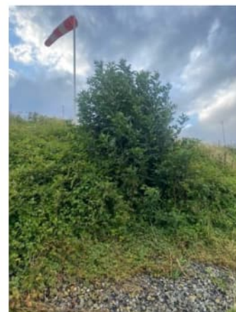
Figuur 1: Begroeiing op het talud
