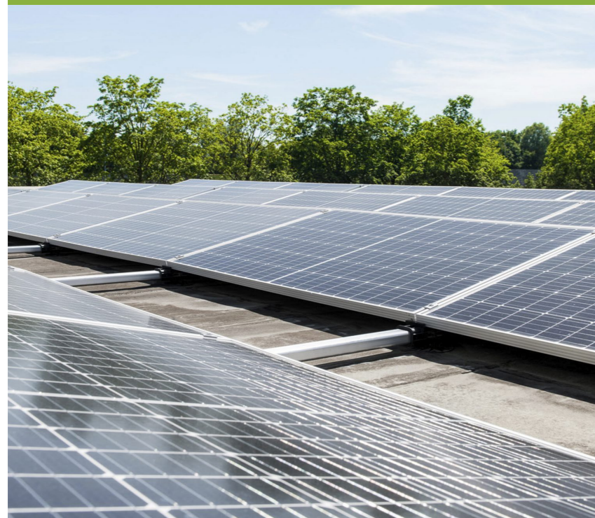
Afb. 28: zonnepanelen op het dak van het bedrijfspand (verplicht).
