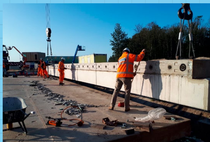
Bij de demontage van het eerste circulaire viaduct was het hoopje voegmiddel het enige afval dat ontstond
