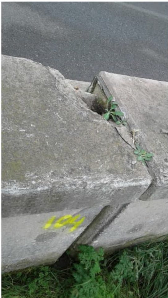
Betonrot bij deformatiemeetpunt 104
