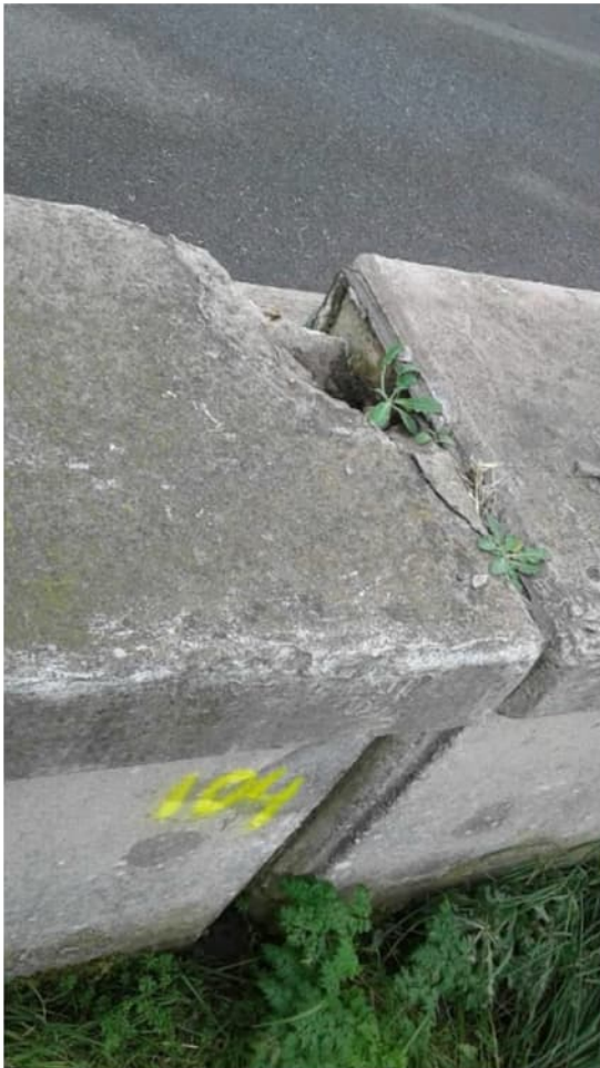
Betonrot bij deformatiemeetpunt 104
