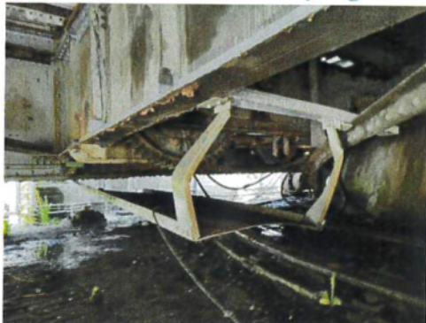
Het bordes onder de aandrijving is beschadigd/verbogen.
