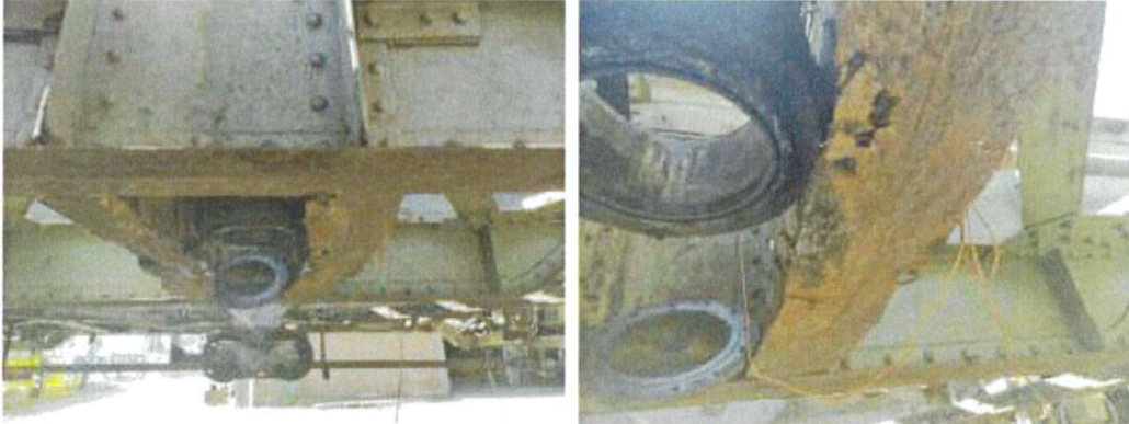
Het frame t.p.v. het draaipunt is krom en zwaar gecorrodeerd
