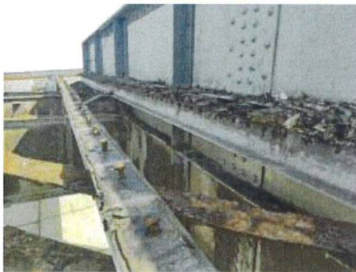
Trottoirplanken zijn defect
