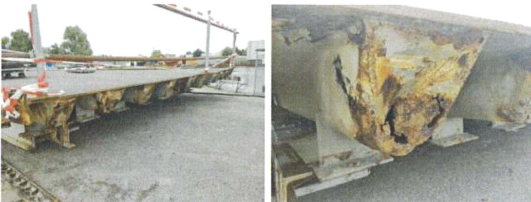
Een groot deel van de uiteinden van de troggen zijn compleet doorgerot.
