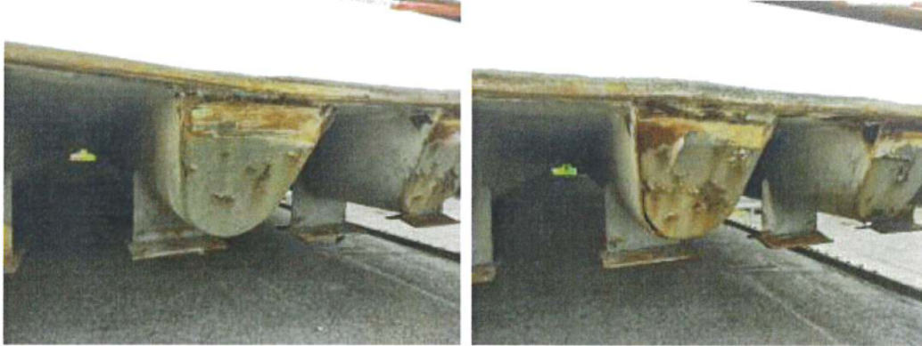
Enkele troggen hebben beschadigingen door de aanvaring.
