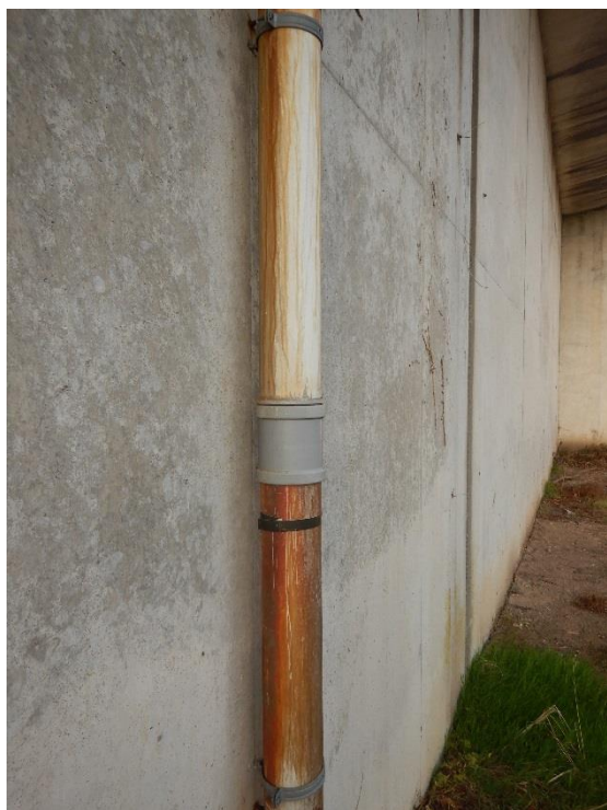
HWA systeem bestaand uit kunststof en PVC onderdelen
