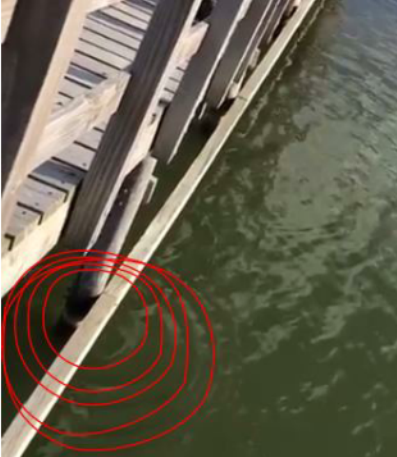
Figuur 6. Paal die los staat bij de brug
