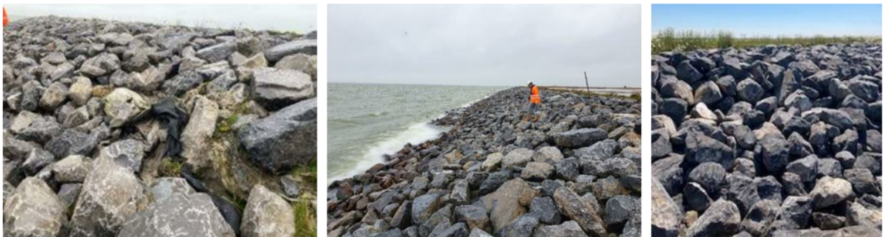
Figuur 2: Impressie van de schade op locatie A (links), B (midden) en D (rechts).
