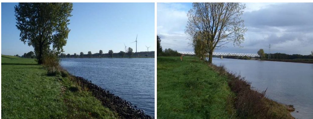
Figuur 3.6 Reguliere oever met stenen oeverbekleding, de bovengrens van de oever ligt daar waar een gesloten grasmat of waar ruigte aanwezig is.
